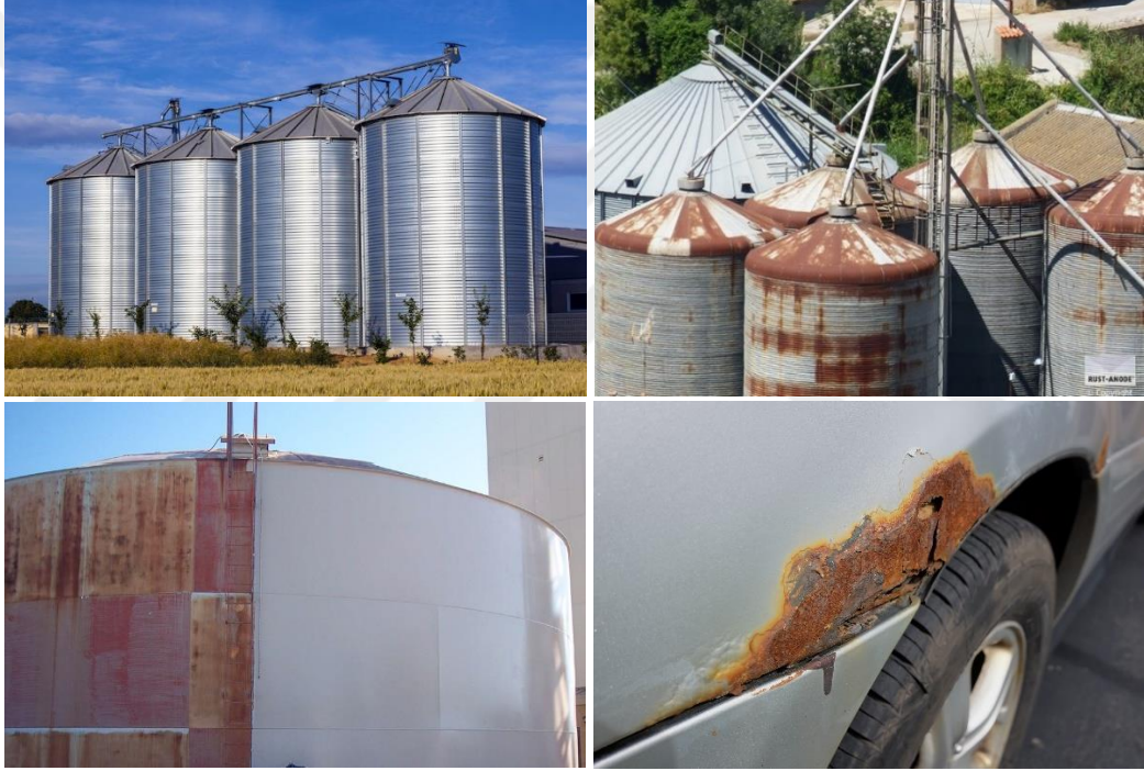
Şekil 2.1. Çeşitli yüzey hasarları ve korozyon örnekleri.
