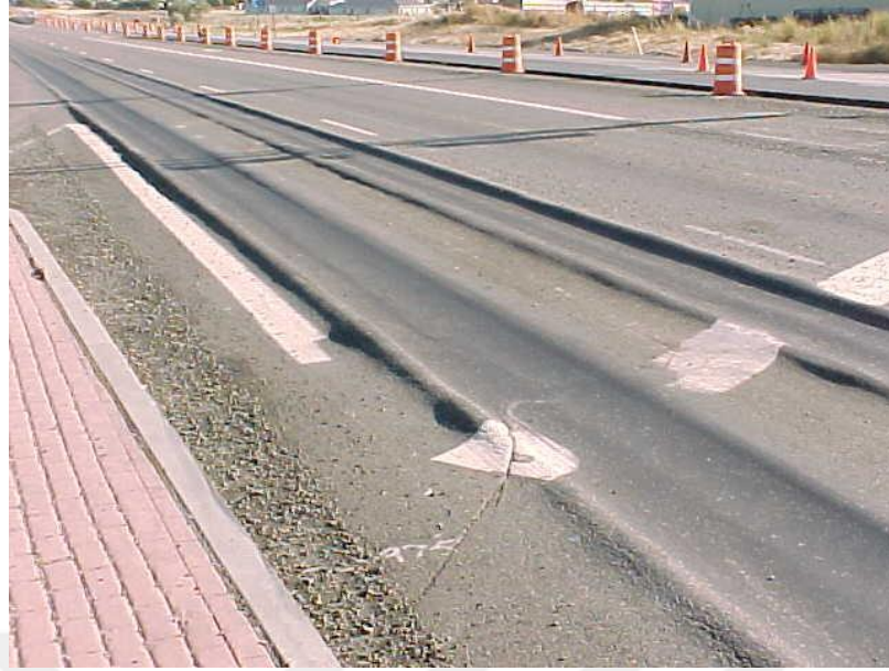
Şekil 2.7. Tekerlek izi oluşumu [1]
