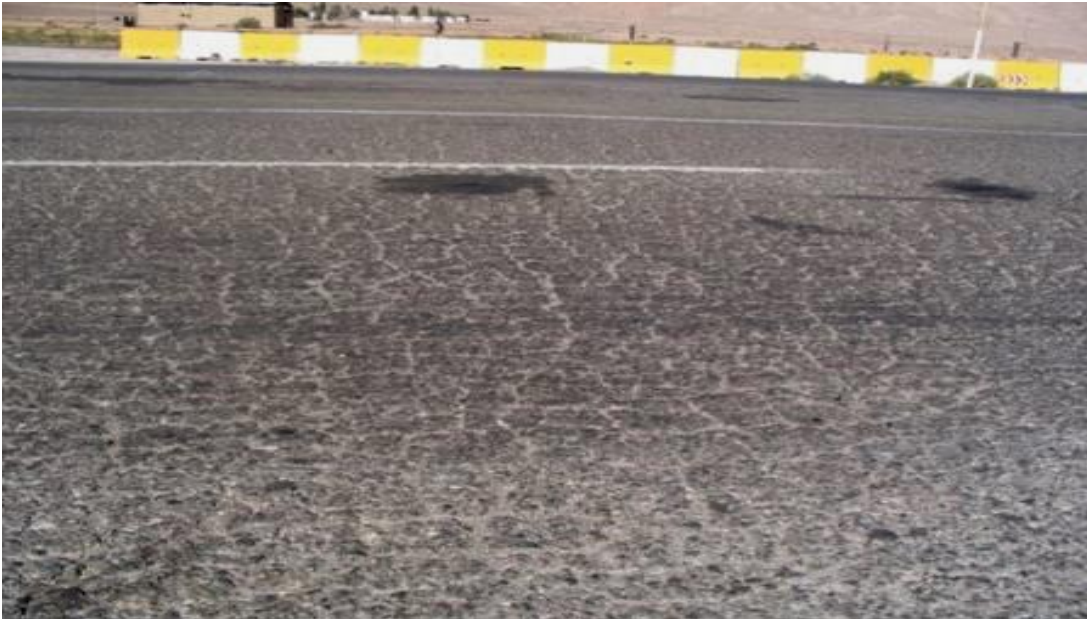
Şekil 2.9 Timsah sırtı çatlaklar
