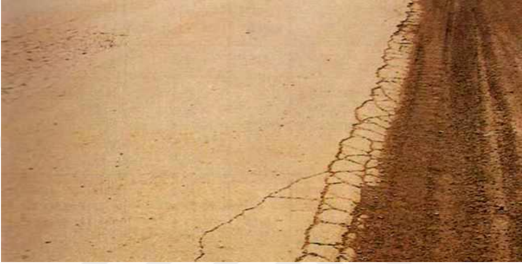
Şekil 2.10 Kenar çatlağı (Kabadayı, 2019)
