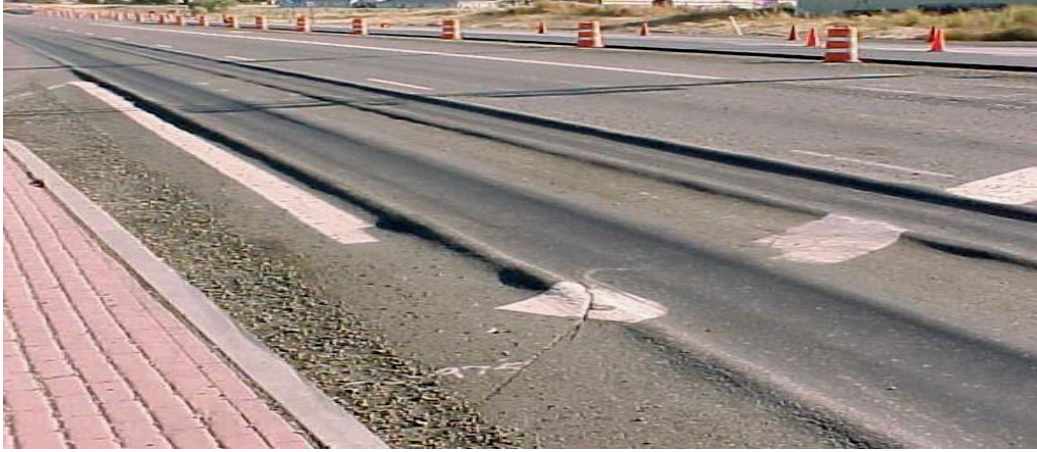
Şekil 2.5 Tekerlek izi oluşumu
