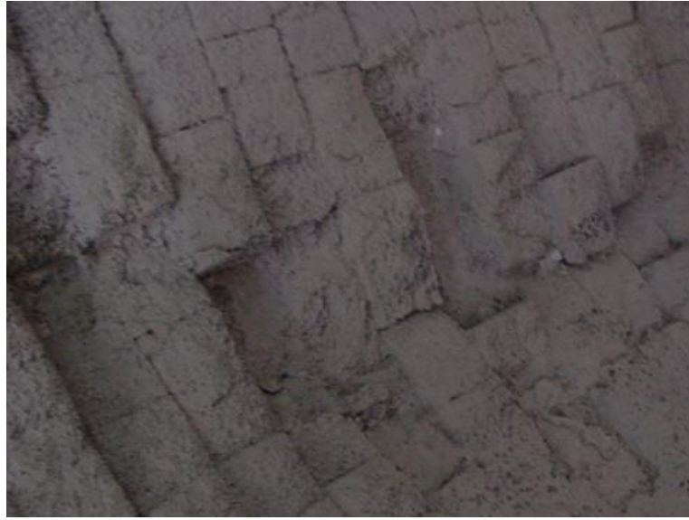
Şekil 3.12.Yeterli Genleşme Boşluğu Verilmemiş MgO-C Tuğla Örümü [22].
