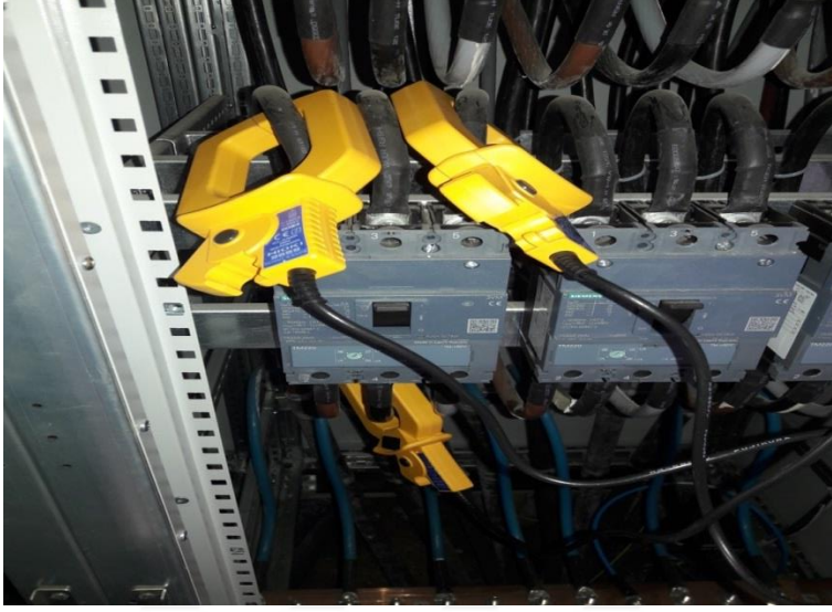
Şekil 2.4. Akım klamplarının kablolarla bağlantısı
