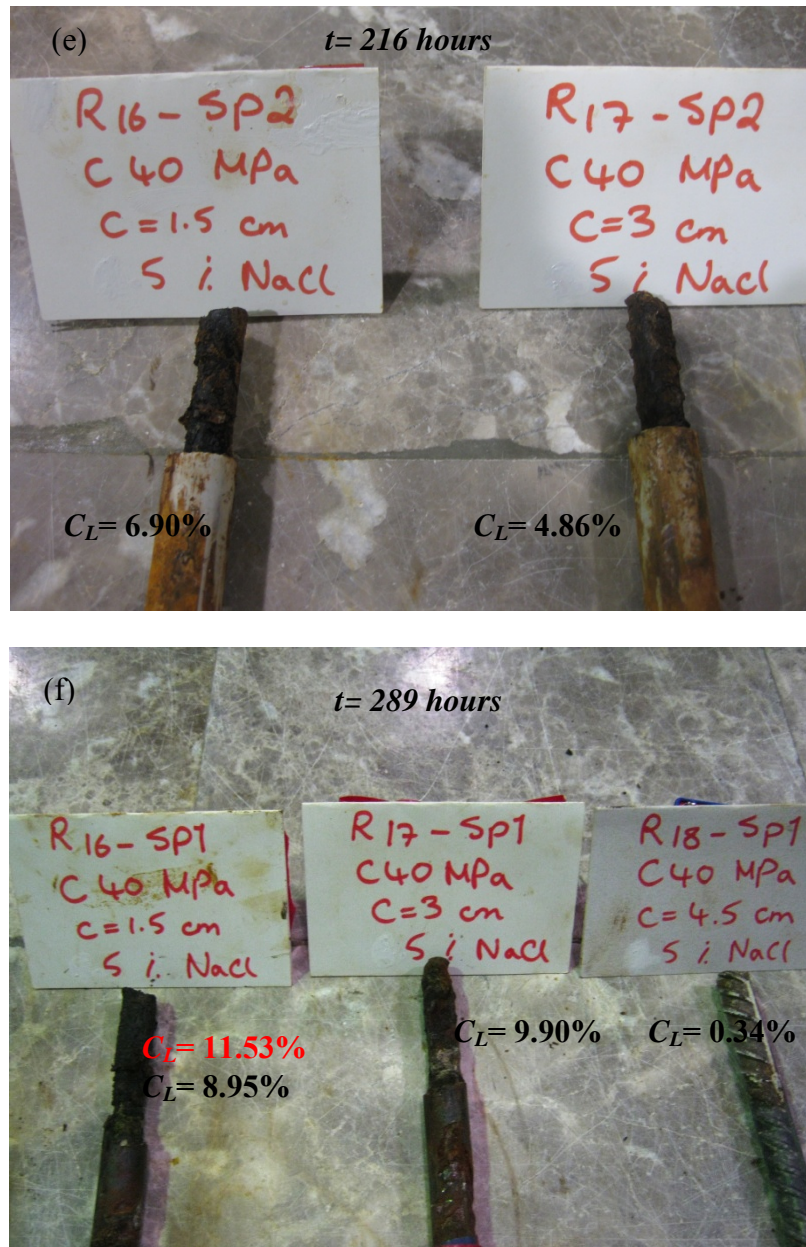
Figure 5.11: Effect of concrete cover depths on corrosion levels: (a) w/c=0.75 ( t=97 h), (b) w/c=0.75 ( t=216 h), (c) w/c=0.75 ( t=289 h), (d) w/c=0.40 ( t=97 h), (e) w/c=0.40 ( t=216 h), (f) w/c=0.40 ( t=289 h).
