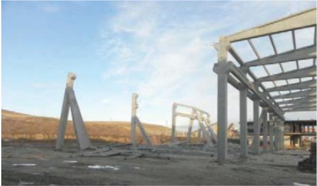
Şekil 2.1 Kolon-kiriş bağlantılarının yetersizliği nedeni ile çatı elemanlarında düşme (Özden ve diğer., 2012)
