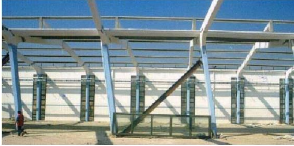
Şekil 2.2 Kolonlarda yanal ötelenme hasarı (Kayhan, 2004)
