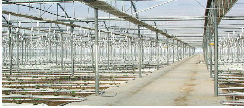
Şekil 1.8 Sıcak su temelli ısıtma sistemi (Ulma agricola, 2024)
