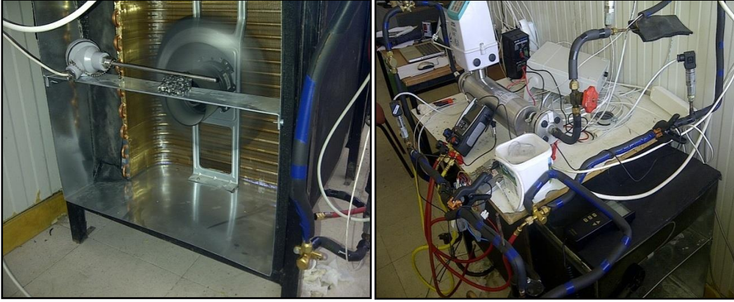
Şekil 3.2. Yoğuşturucu ve ısı yalıtımı yapılmış kanal
