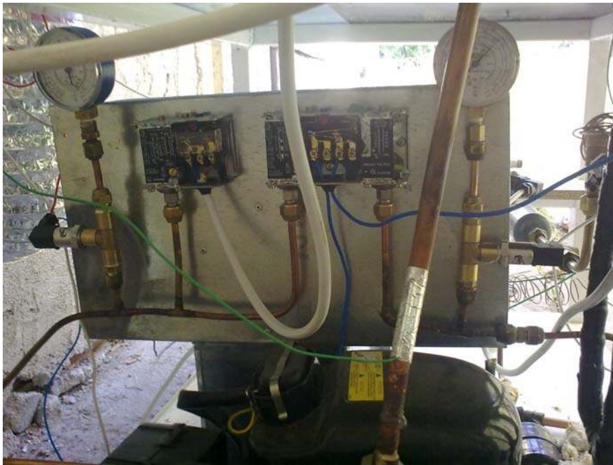
Resim 5.3. Manometrelerin ve basınç transmitterlerin bağlantısı
