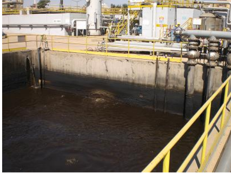
Şekil 3.7. Batman Rafinerisi AAT Dengeleme Havuzu
