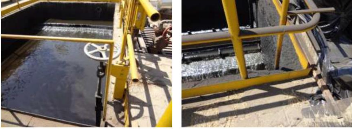
Şekil 3.6. Batman Rafinerisi AAT PPI Ayırıştırıcıları
