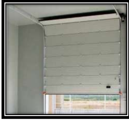
Şekil 5.2 Test odası araç giriş kapısı
