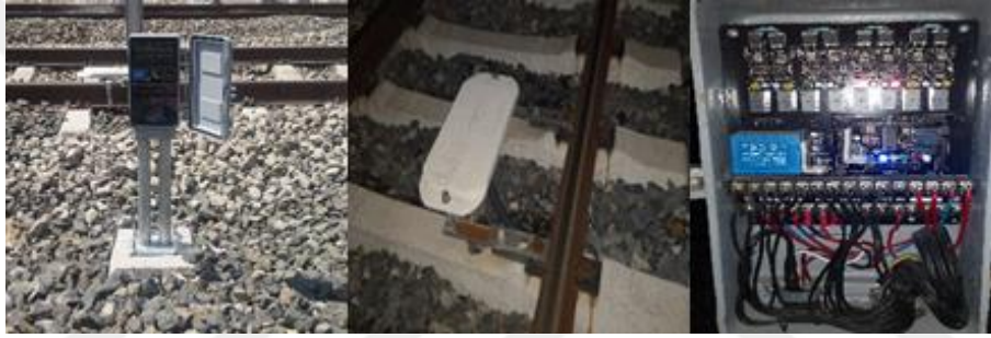
Resim 3.22. Ats ekipman montajı
