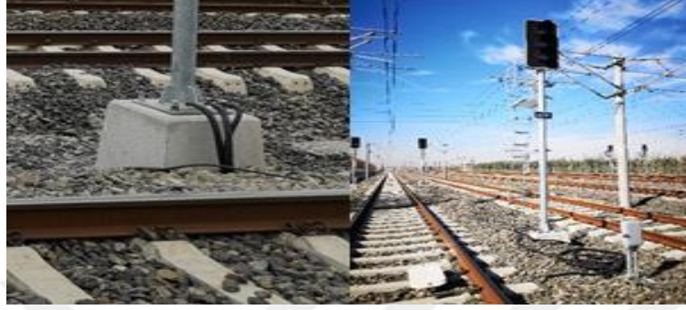
Resim 3.16. Üçlü yüksek sinyal montajı
