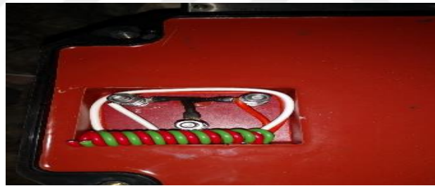
Resim 3.8. N-Tipi ray devresi iç terminasyonu
