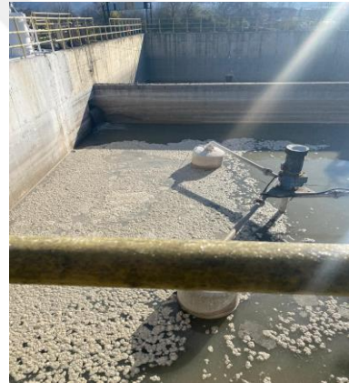
b. Atık su arıtma ikinci aşama
