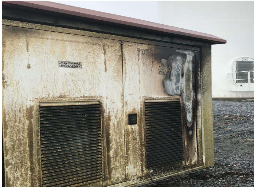
Şekil 7.6. Kompanzasyon panosunun yanması sonucu köşkte oluşan hasar
