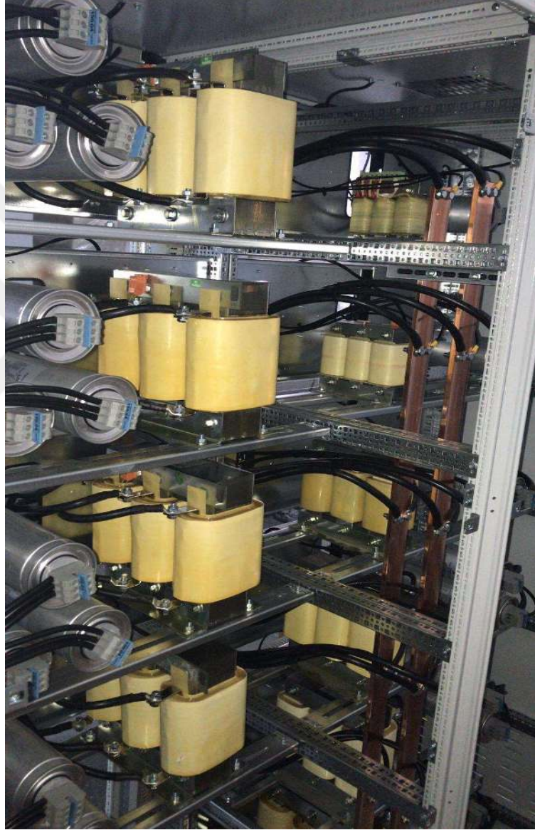
Şekil 5.9. Pasif harmonik filtre kompanzasyon panosu iç görünümü
