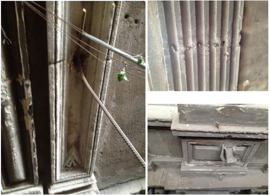
Şekil 4.13 : Niteliksiz ekler sebebiyle oluşan tahribatlar.
