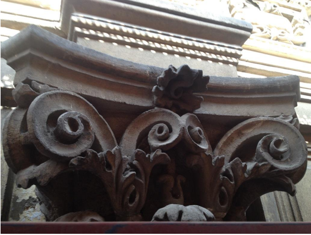
Şekil 4.11 : Karakabuk sebebiyle dış cephe taşlarında meydana gelen renk değişimi.
