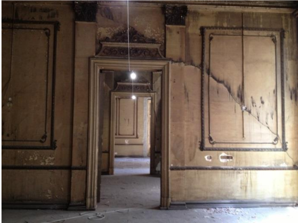
Şekil 4.19 : Kapı üzerinde bulunan bezemelerdeki tahribatlar.
