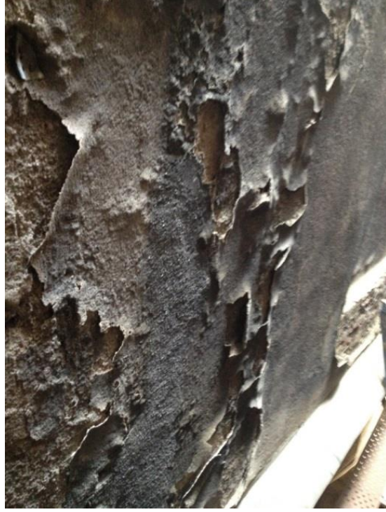
Şekil 4.7 : Yeşilçam cephesinde oluşan kabuklanma.
