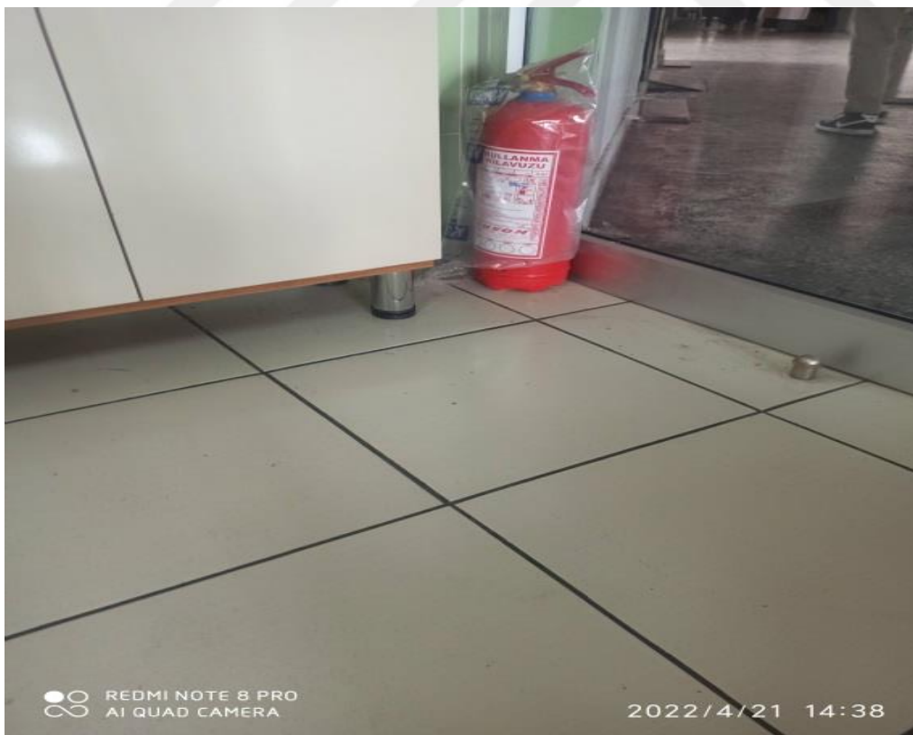
Şekil 4.6. Yangın tüpünün yanlış konumlandırılması.
