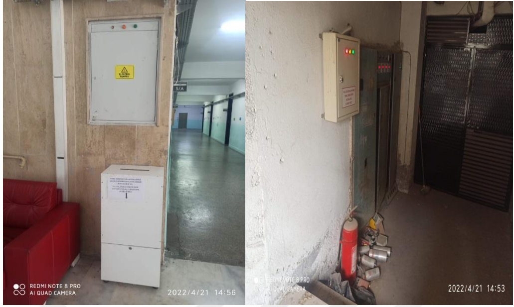
Şekil 4.22. Elektrik panolarını önünde kauçuk paspas olmaması.
