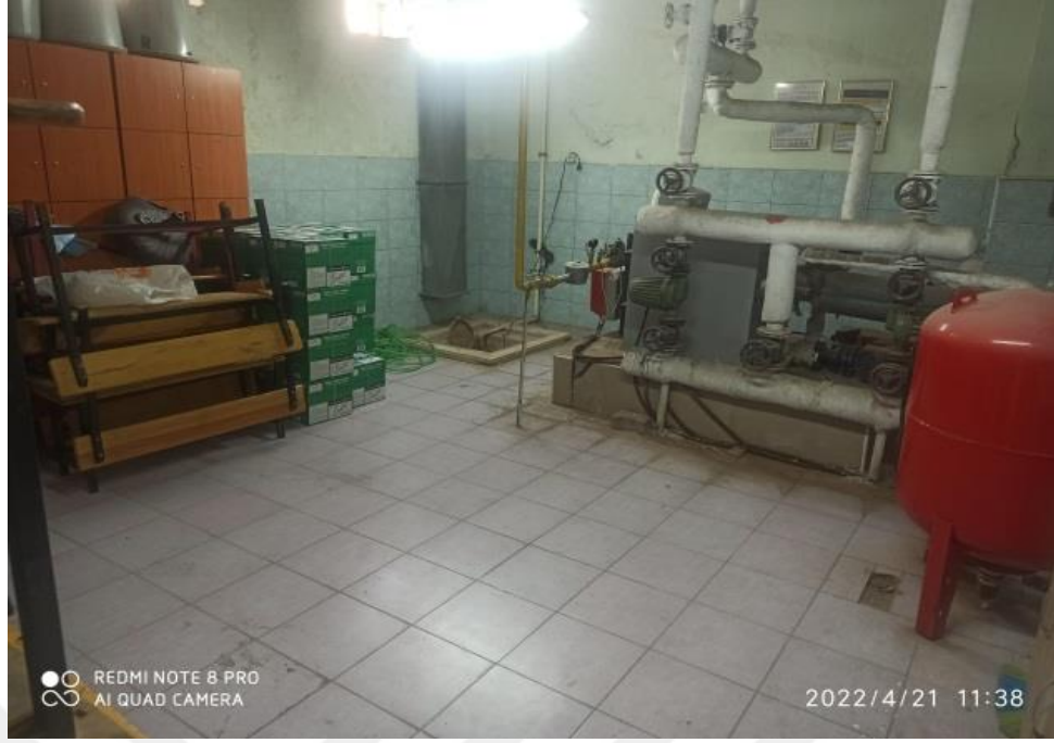
Şekil 4.29. Kazan dairesi çevresinde yanıcı malzemelerin olması.
