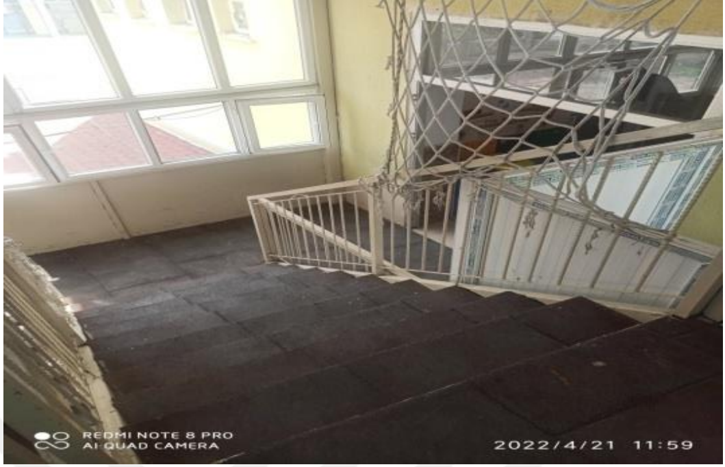
Şekil 4.33. Yangın merdivenlerinin normal çıkış merdiveni olarak kullanılması.
