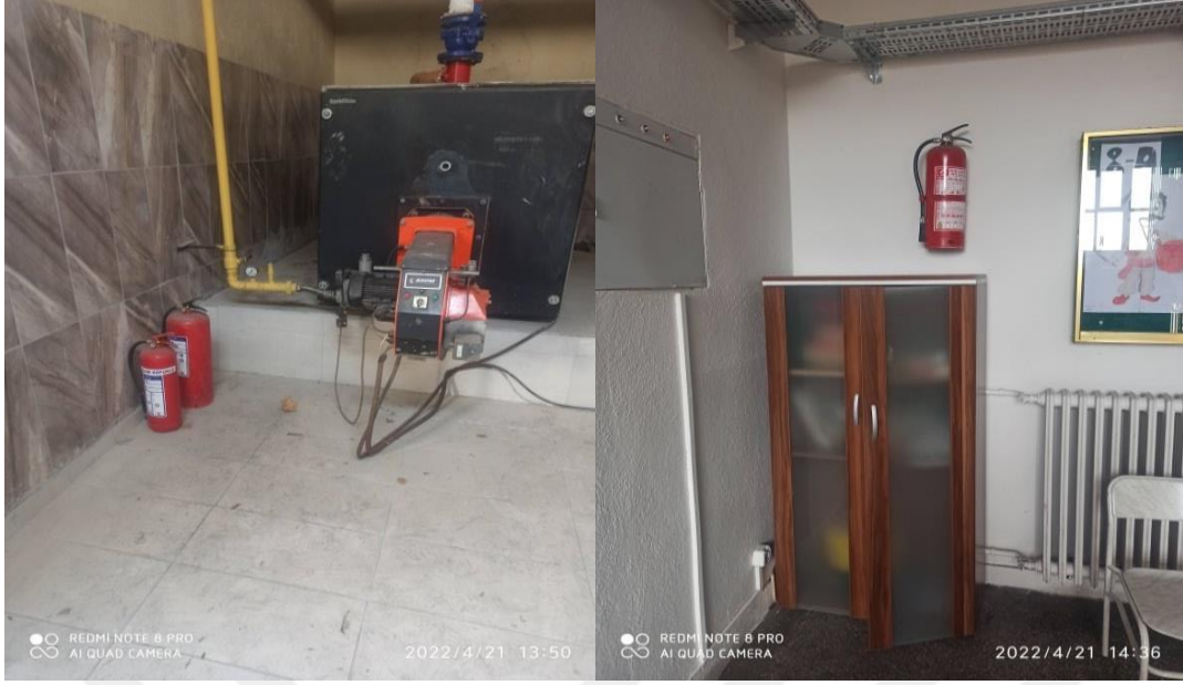
Şekil 4.20. Yangın söndürücülerin yanlış konumlandırılması.
