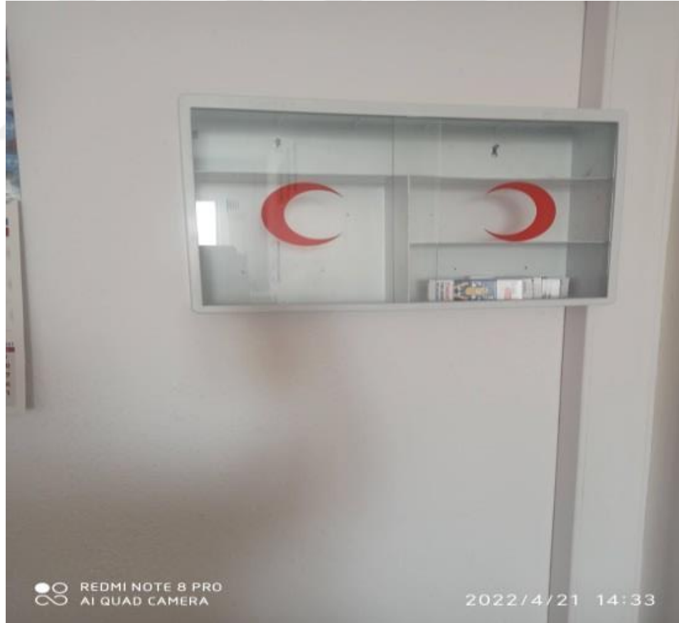
Şekil 4.23. İlk yardım dolabında gerekli malzemelerin olmaması.
