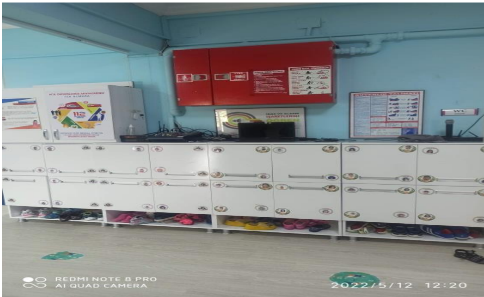
Şekil 4.37. Yangın dolabına ulaşımın engellenmesi ve yanlış konumlandırılması.
