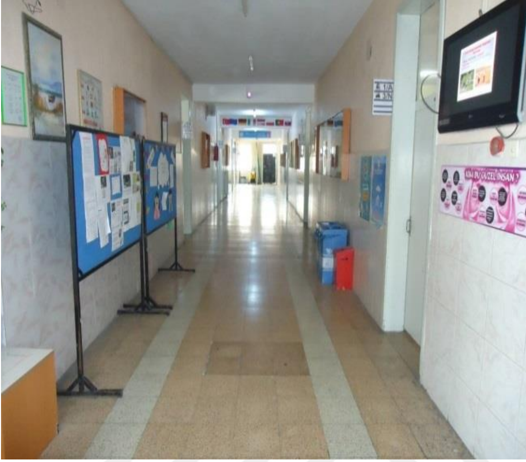
Şekil 4.24. Uyarı ve ikaz levhalarının olmaması.
