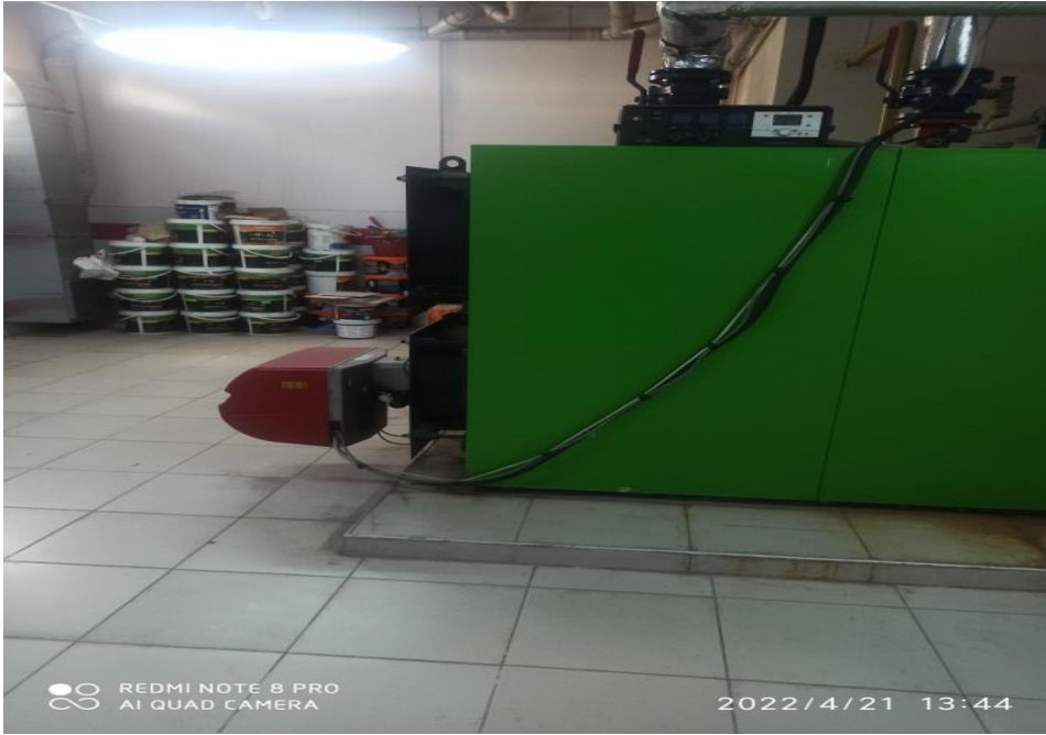
Şekil 4.17. Kazan dairesi çevresinde yanıcı malzemelerin konulması.
