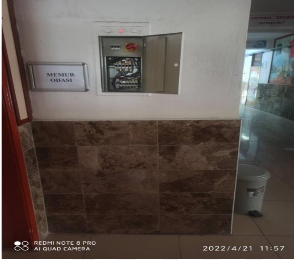
Şekil 4.31. Elektrik pano kapaklarının açık olması.
