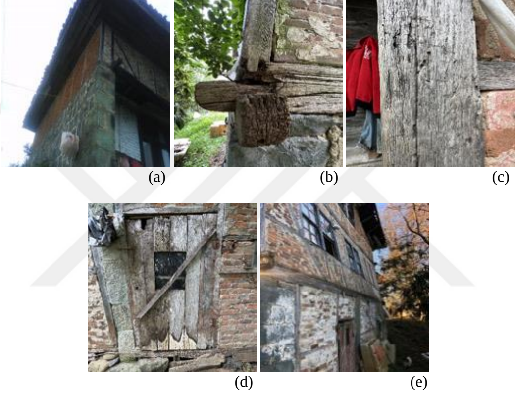
Şekil 95. (a) Çatı taşıyıcılarındaki bozulma, (b) Ağaç malzemenin birbirine geçtiği enine kesitlerde rutubete bağlı deformasyon (c) Dikmede renk değişikliği ve böcek tahribatı (d) Yüzey erozyonu ve çürüme, (e) Yapının zemininde kayma sebebiyle taşıyıcı duvarda oluşan bombe
