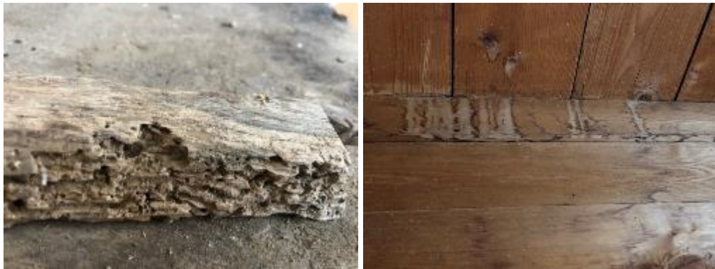
Şekil 119. Gedik Konağı ahşap yapı elemanlarında tespit edilen böcek tahribatı
