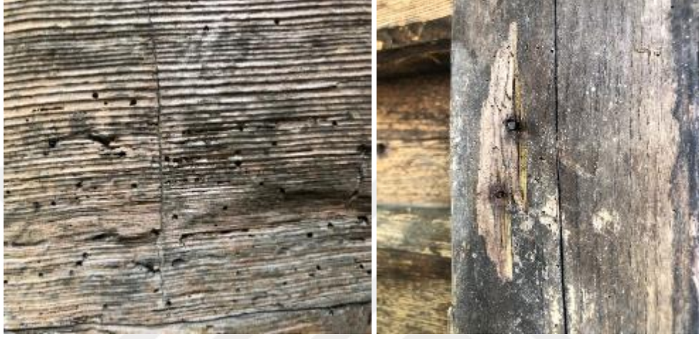
Şekil 120. Biryol Evi ahşap yapı elemanlarında tespit edilen böcek tahribatı
