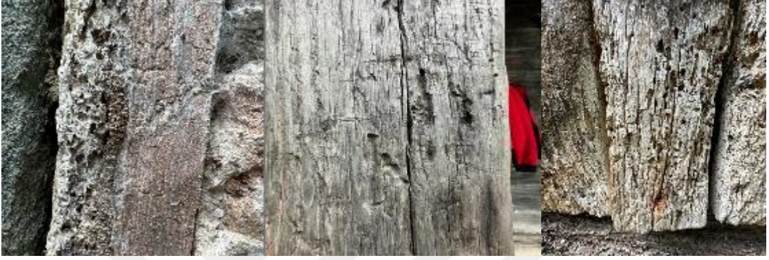
Şekil 116. Aydoğan Evi ahşap yapı elemanlarında tespit edilen böcek tahribatı
