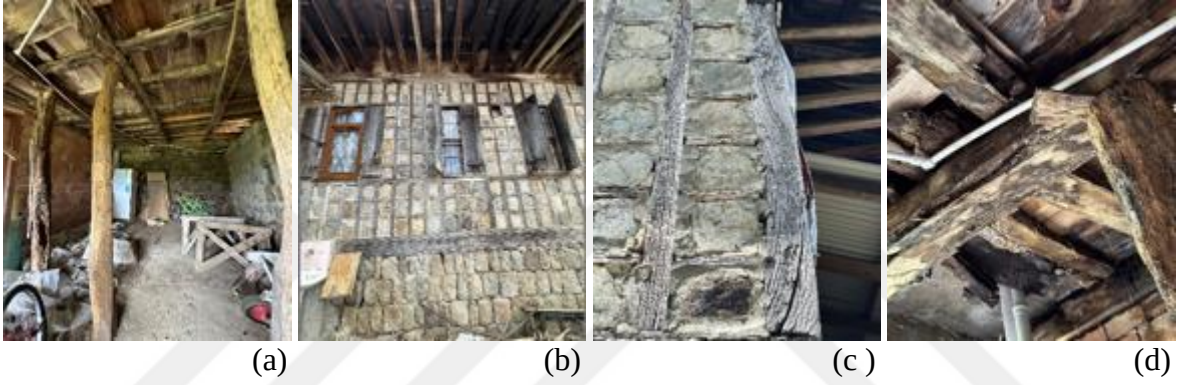
Şekil 110. (a) Bodrum kat mantar çürüklük ve böcek tahribatına maruz kalan dikme ve kirişlerin görünümü, (b) Rutubete maruz kalan çatı taşıyıcıları, (c) Dikmede lif eğrilği, (d) Bodrum kat ahşap taşıyıcı kirişlerde mantar çürüklük
