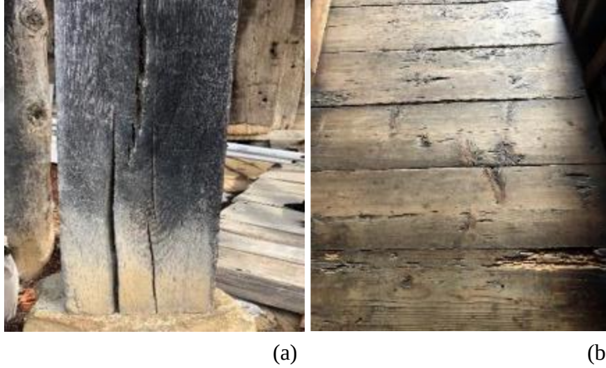
Şekil 80. (a) Batıya yönündeki dikmede çatlak oluşumu (a) Ev içi zeminde oluşan mekanik aşınma ve böcek tahribatı (c) Rutubetin çatı saçaklarına etkisi (d) UV degradasyonu (e) Hava şartlarının (yağmur, kar suyu) kapı doğramasında oluşturduğu yüzey erozyonu (yıkınma) (f) Enine kesitlerde oluşan çatlakların görüntüsü
