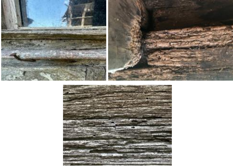
Şekil 114. Zihni Evindeki ahşap yapı elemanlarında tespit edilen böcek tahribatı
