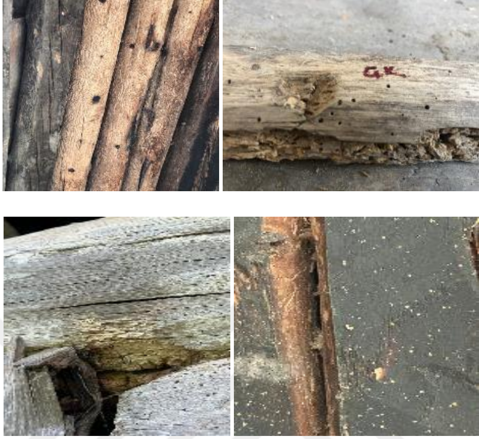
Şekil 117. Çetinkaya Evine ahşap yapı elemanlarında tespit edilen böcek tahribatı
