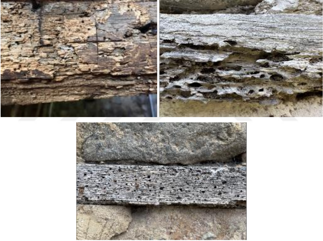
Şekil 115. Esat Evi ahşap yapı elemanlarında tespit edilen böcek tahribatı
