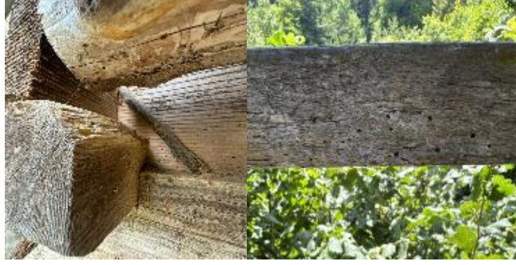
Şekil 118. Gedik Konağı Serenderin ahşap yapı elemanlarında tespit edilen böcek tahribatı
