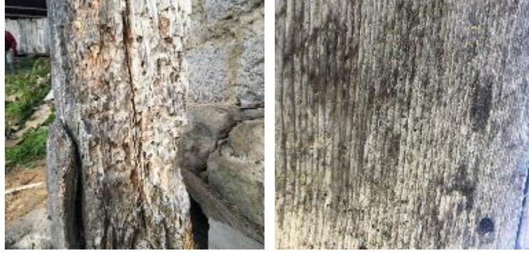
Şekil 121. Melikoğlu Konağı Baba Evi ahşap yapı elemanlarında tespit edilen böcek tahribatı
