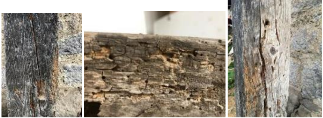
Şekil 122. Melikoğlu Konağı ahşap yapı elemanlarında tespit edilen böcek tahribatı
