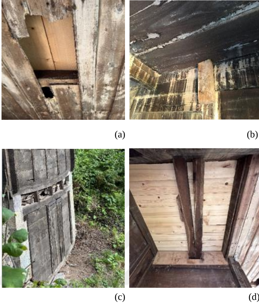
Şekil 55. (a) Restorasyon sonrası tavan döşeme görüntüsü (b) Ahşapta mantar çürüklüğü (c) Zemin taşıyıcısının görünümü ve yoğun UV degradasyonu, (d) Restorasyon sonrası tavan döşemesi
