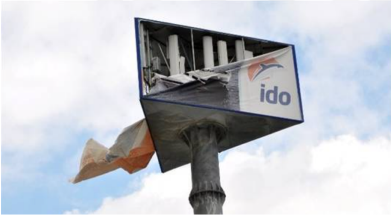
Şekil 16. Totem içersine gizlenmiş baz istasyonları (URL-4)
