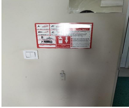
Şekil 4.21. Mutfak yangın söndürme tüpü
