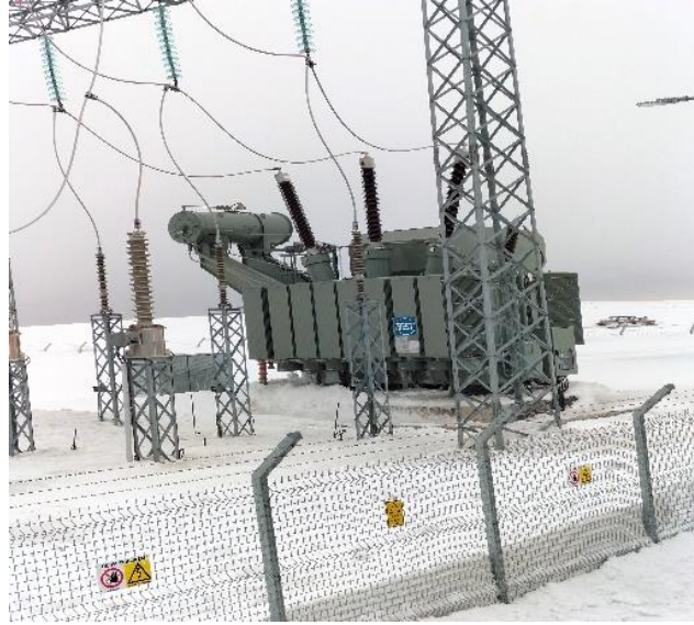
Şekil 4.28. Trafo köşkünde bulunan parafudr
