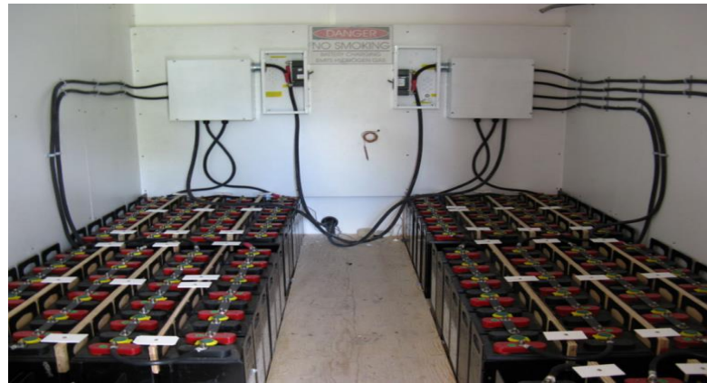
Şekil 4.11. Fotovoltaik Sistemdeki Enerjiyi Depo Eden Aküler (“Mutlu Akü - Mini Trak- Full Enerji Akülerinin teknik özellikleri,” )
