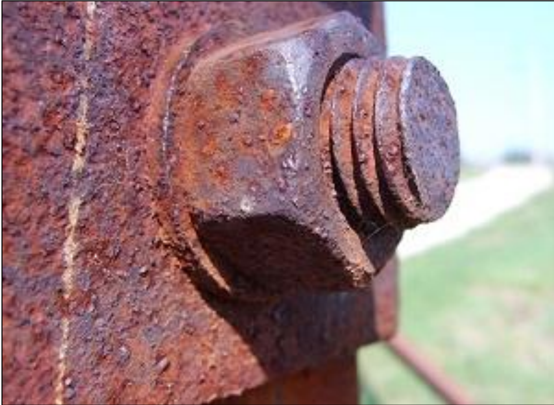
Şekil 9: Korozi aşınma (URL-6, 2017).
