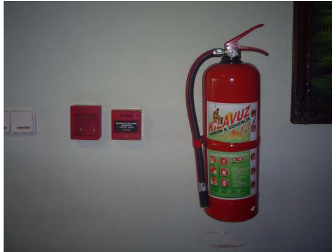
Fotoğraf 4.10. Yangın Alarmları ve Yangın Tüpü
