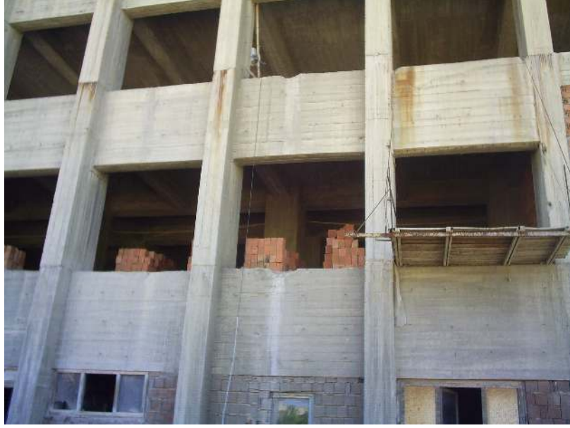
Fotoğraf 4.9. Donatılarda Başlayan Korozyon
