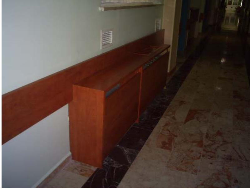
Fotoğraf 4.14. Merkezi Havalandırma Sistemi ve Lokal Klimalar
