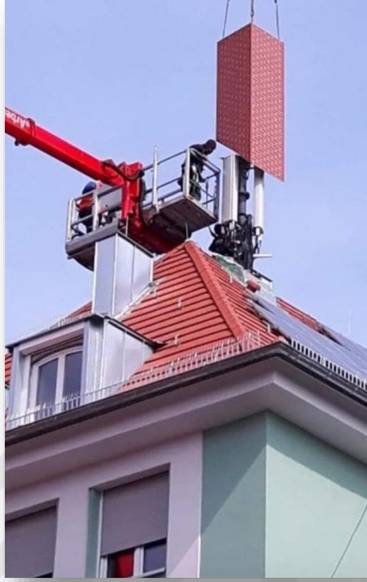
Şekil 2.22 Çatıda sahte baca görünümü ile GSM baz istasyonunun gizlenmesi (İmgur,2020)
