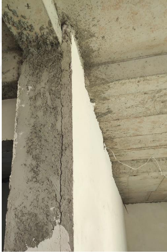
řekil 4.1. Fazla kalınlıkta uygulanmış kaba sıva imalatı
