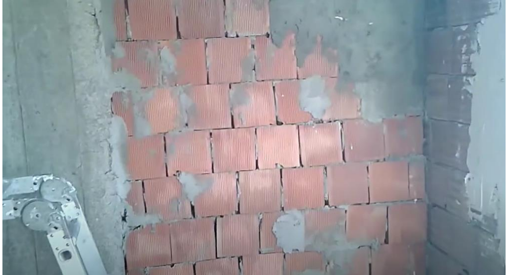
Şekil 4.2. Duvar uygulama projesi olmadan, tekniğe uygun yapılmayan duvar imalatı
