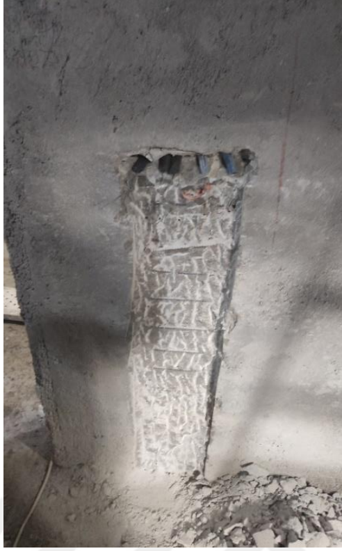
Şekil 4.5. Elektrik tesisat uygulamasında betonarmeye verilen zarar
