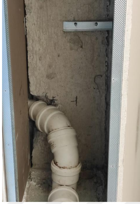
Şekil 4.8. Asma tavan kot düşürülmemesi için betonarmeye zarar verilerek geçirilen pis su tesisatı
