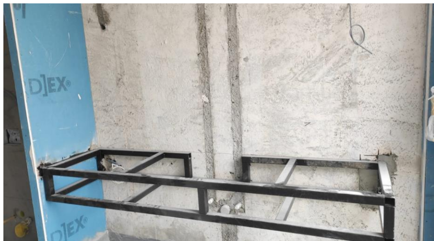
Şekil 4.21. Mermer kaplama yüzeyine hatalı çekilen alçı sıva ve daha sonra alçı kazınan duvar yüzeyi
