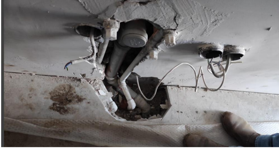
Şekil 4.23. Dolap imalatına göre yapılmayan tesisat imalatının düzeltilmesi
