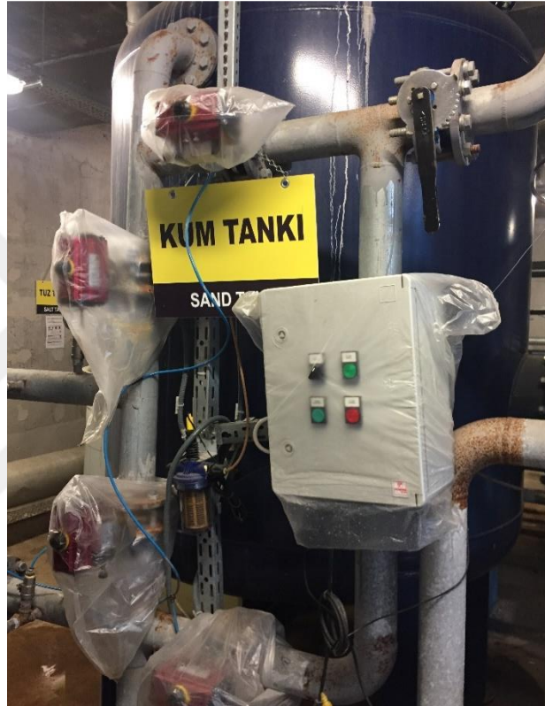
Şekil 6.4. Yumusatma tesis kum tankı ünitesi
