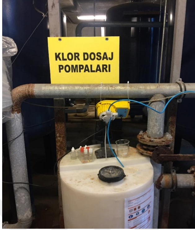
Şekil 6.6. Klorlama ünitesi (klor dozaj pompası).
