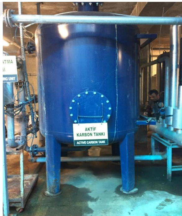
Şekil 6.5. Yumusatma tesisi aktif karbon tankı
