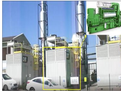
Şekil 5.31. Gaz motorları ve koruyucu konteynırlar
