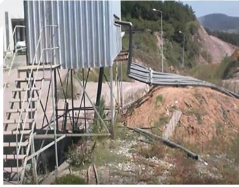
Şekil 5.30. Yatay boruların birleşip tek gaz borusu halinde çıkışı
