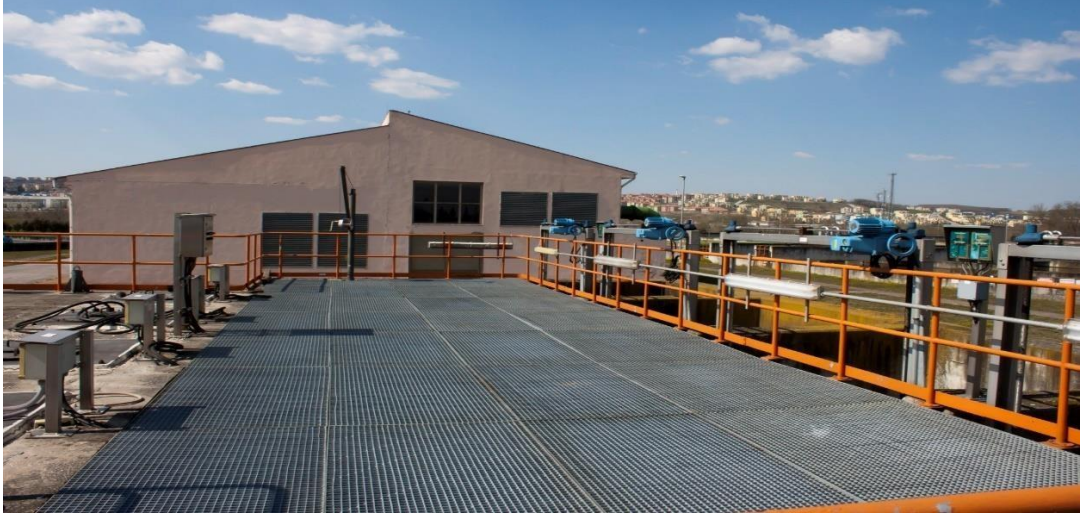
Şekil 3.8. Geri Devir İstasyonu
