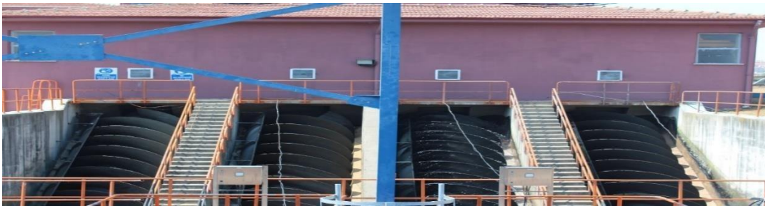
Şekil 3.2. Karaman Atıksu arıtma tesisi giriş terfi istasyonu
