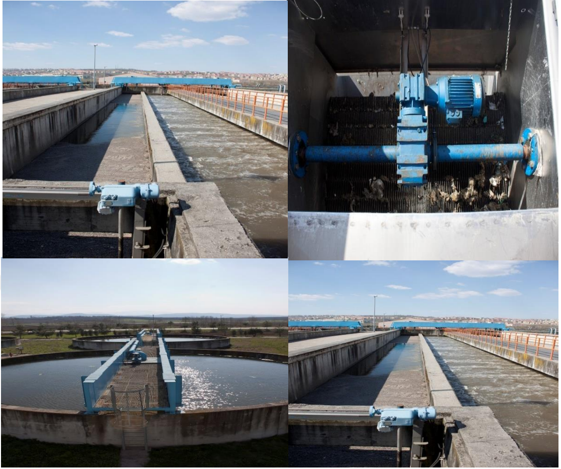
Şekil 5.2. Karaman atık su arıtma tesisi-2 [43]
