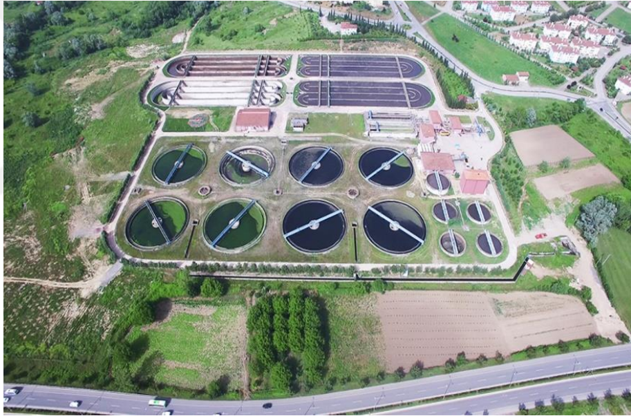
Şekil 5.1. Karaman atık su arıtma tesisi-1[43]
