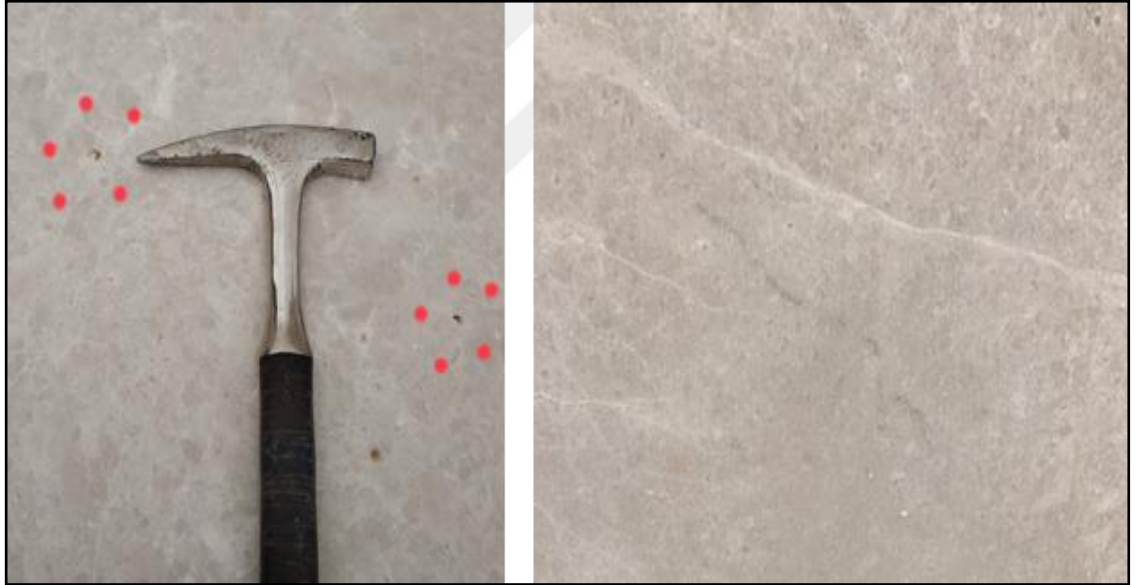
Şekil 4.2. Mermer bloğu üzerindeki küçük boşluklar ve kılcal çatlaklar
