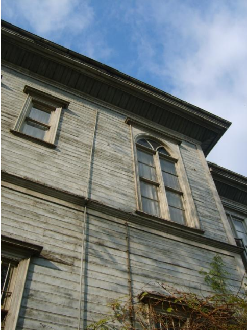
Resim 4.4-7. Güneydoğu cephesi (D görünüşü) – D7 duvarı P4 penceresi
