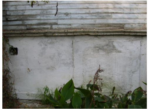
Resim 4.4-4. Güneydoğu cephesi (D görünüşü) – D1 duvarı P5-5 penceresi
