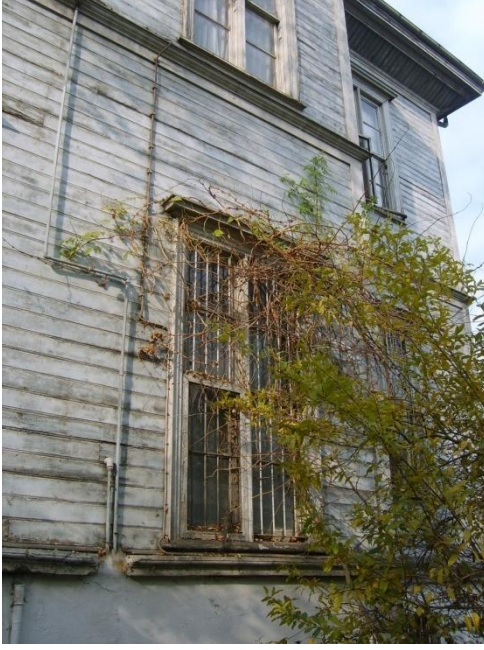
Resim 4.4-5. Güneydoğu cephesi (D görünüşü) – D4 duvarı P2-6 penceresi
