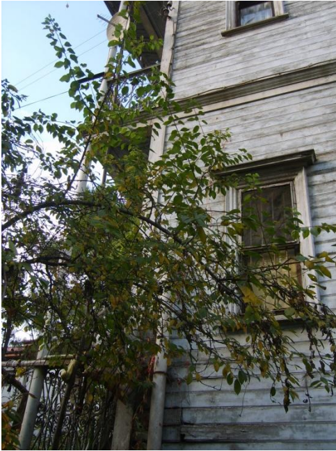
Resim 4.4-3. Güneydoğu cephesi (D görünüşü) – D4 duvarı P3-2 penceresi
