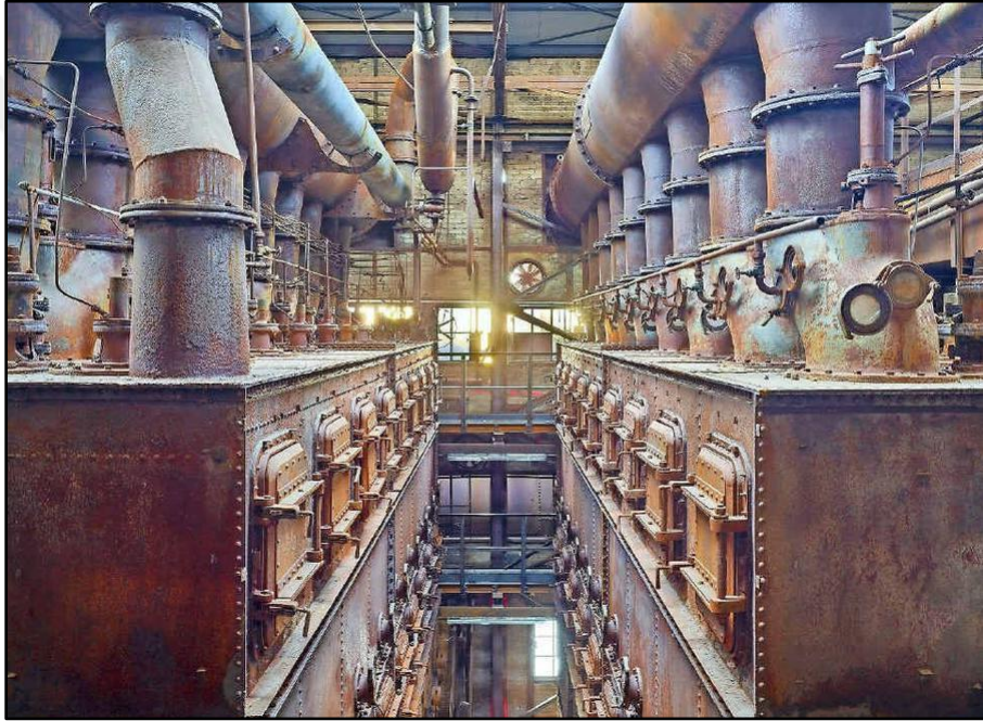
Fotoğraf 58. Völklingen Demir İşletmesi, çökme tehlikesi altında olan gaz tesisi (Elss-Seringhaus, 2016)
