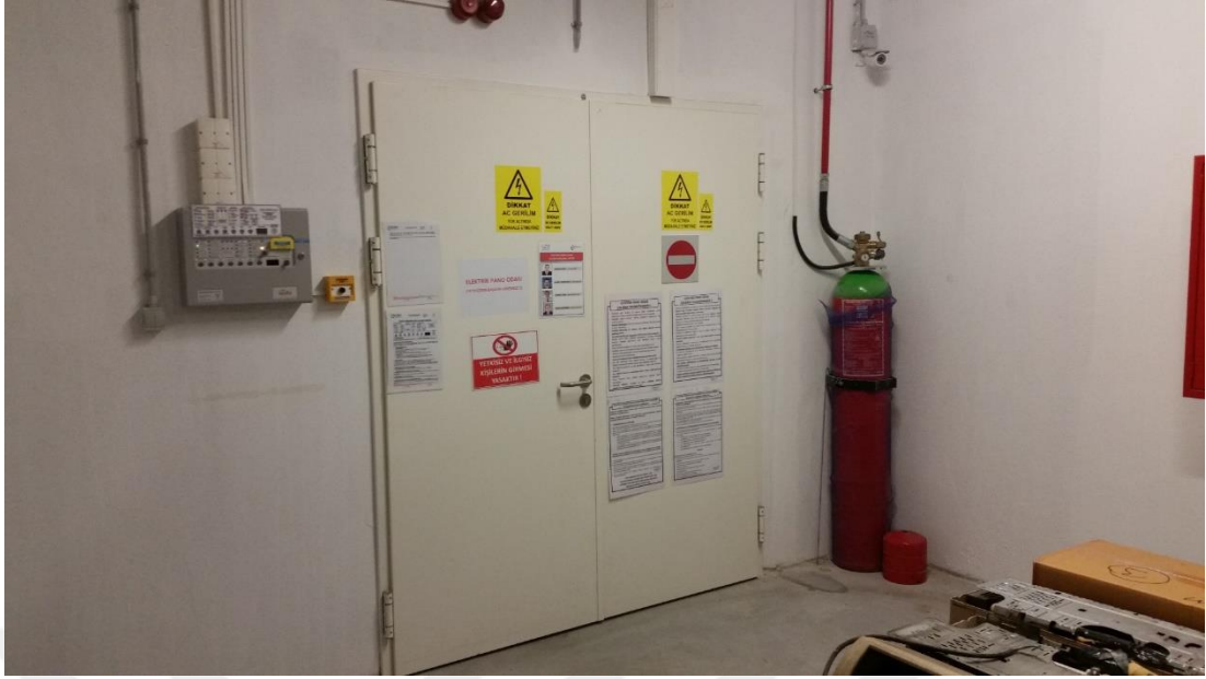
Şekil 2.23. Gazlı söndürme sistemi genel görünümü
