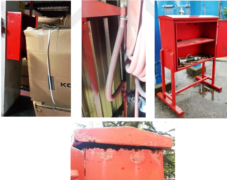
Şekil 2.46. Yangın ve hidrant ekipman dolapları
