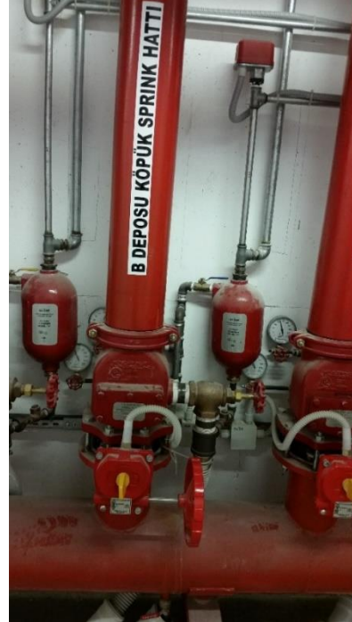
Şekil 2.3. Islak alarm vanasına ait 2.görsel
