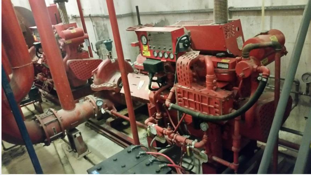
Şekil 2.31. Dizel yangın pompası görseli
