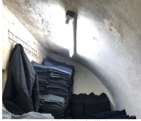
Şekil 3.50 Mahzen odalarında niteliksiz sıva uygulaması
