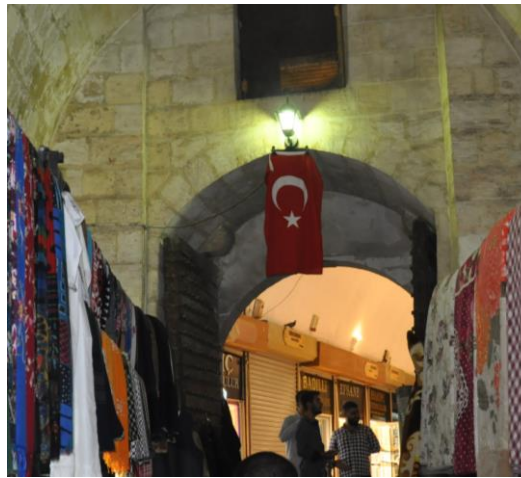
Şekil 3.49 Kapı kemer aynası niteliksiz sıva uygulaması
