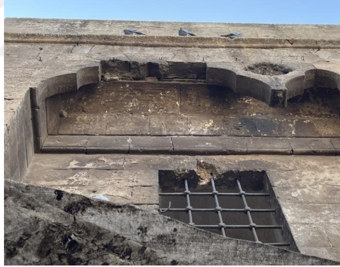
Şekil 3.53 Saçak kısmında kopan sarkıt
