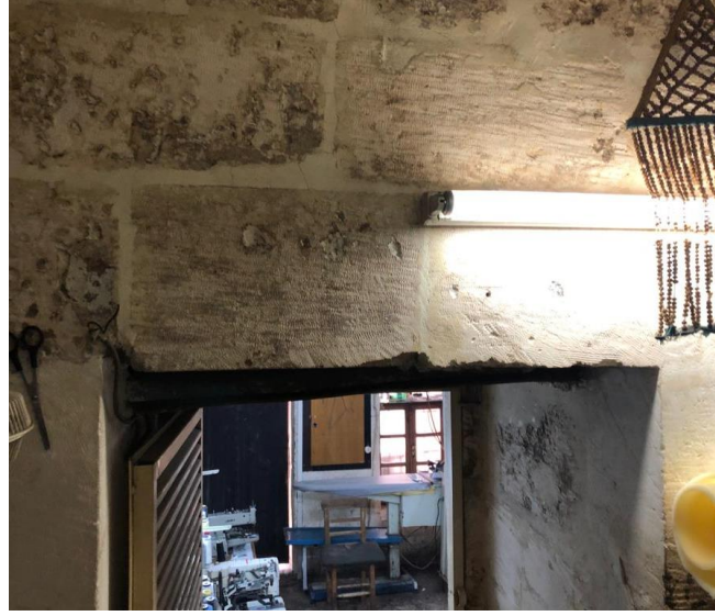
Şekil 3.98 Düzensiz kapı geçişi
