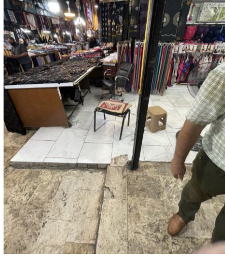
Şekil 3.40 Niteliksiz zemin ve duvar kaplamaları
