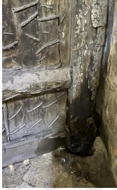
Şekil 3.65 Kapı alt kısmında bozulma
