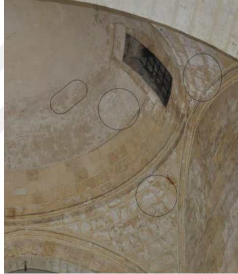
Şekil 3.61 İç yüzeyde tuzlanmalar
