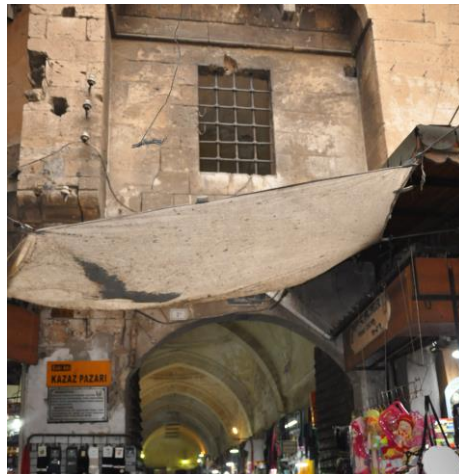
Şekil 3.51 Doğu cephesinde derz boşalmaları
