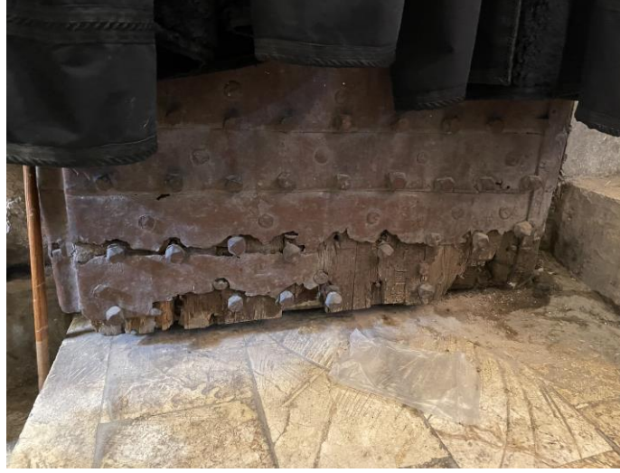
Şekil 3.69 Korozyona uğrayan demir levha
