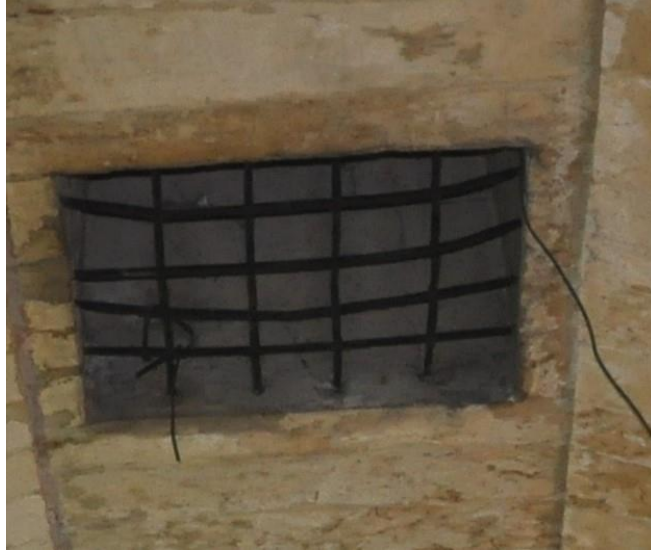
Şekil 3.67 Korozyona uğrayan parmaklık
