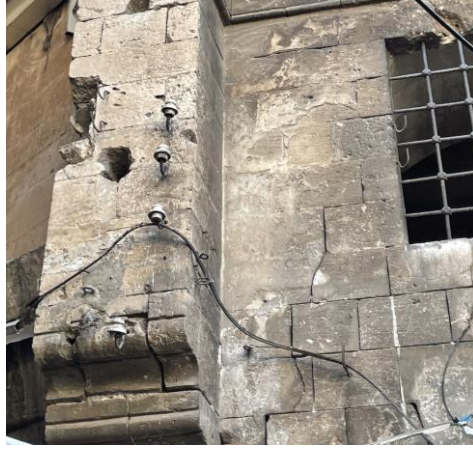
Şekil 3.54 Taşlarda çatlama ve yüzey kaybı
