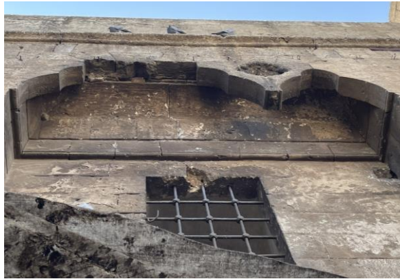
Şekil 3.57 Doğu cephesinde kirlenme ve kararmalar
