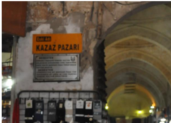
Şekil 3.62 Doğu cephesinde çimento sıvalı yüzeyde tuzlanma
