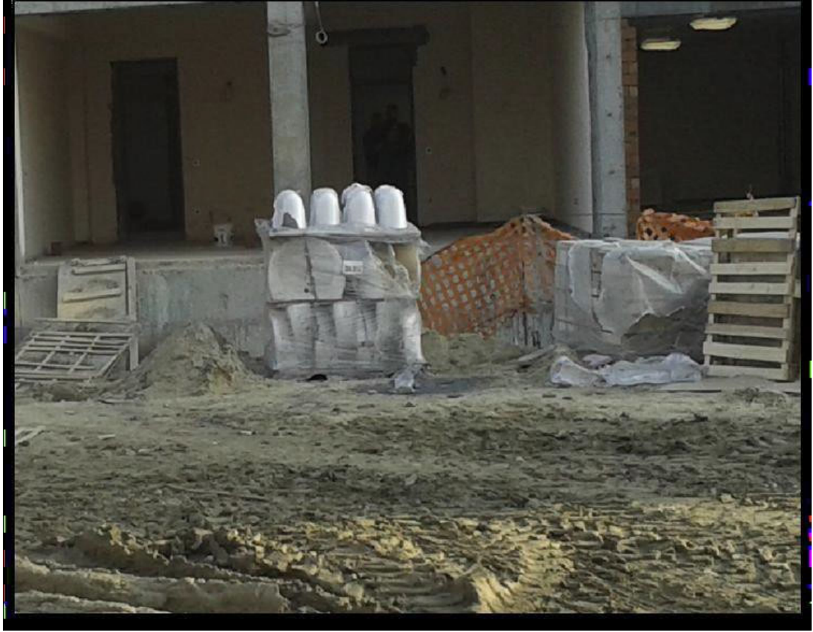
Şekil 7.1. Uygunsuz depolama ile zarar gören vitrifiye malzemeleri (Balaban, 2014).
