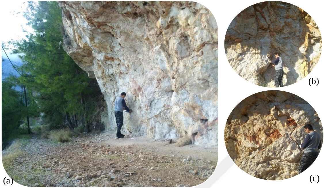
Şekil 4.10. a) 4 nolu lokasyonda 8 nolu şeve ait genel görünüm; b) ve c) de çatlak görünümleri
