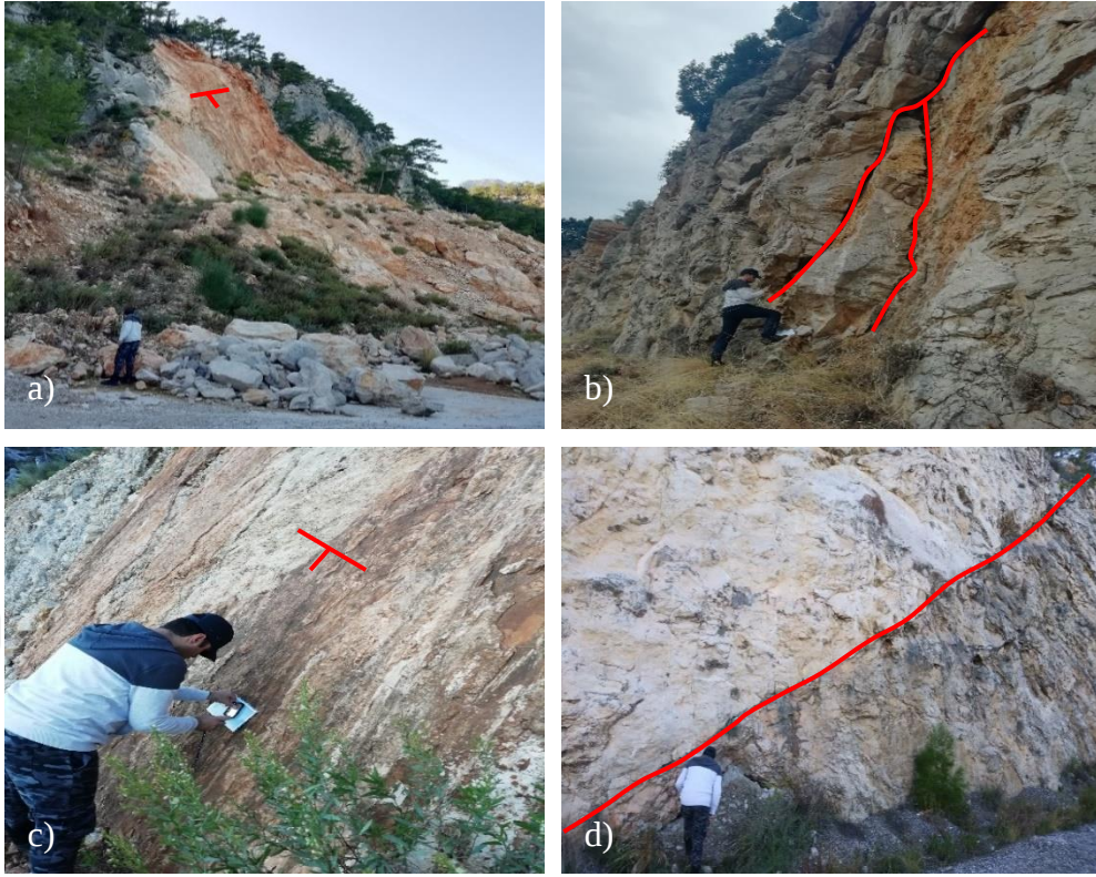
Şekil 3.2. Karayolları üzerindeki çeşitli süreksizliklere ait fotoğraflar. a) 4 nolu lokasyonda heyelana ait bir görünüm; b) 1 nolu lokasyonda; bir nolu şeve ait çatlak görünümleri; c) 4 nolu lokasyonda; fay düzlemi ölçümü; d) 4 nolu lokasyonda çatlak görünümü
