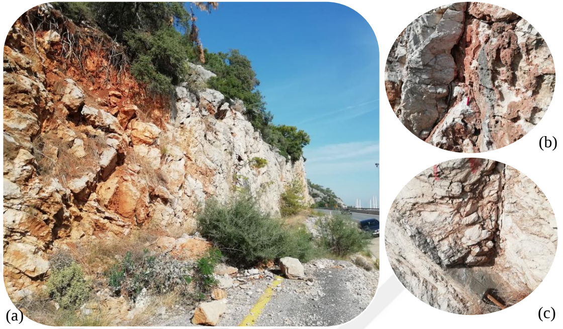
Şekil 4.4. a) 1 nolu lokasyonda 2 nolu şeve ait genel görünüm; b) ve c) de çatlakların detaylı görünümü
