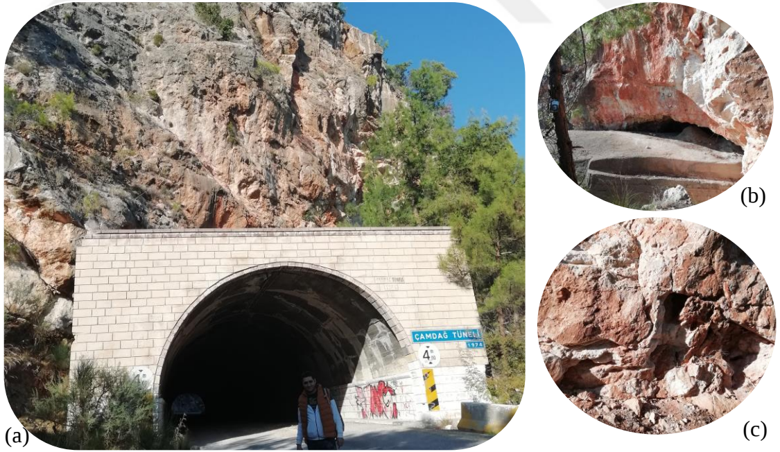
Şekil 4.9. a) 4 nolu lokasyonda, tünel üzerinde oluşturulan 7 nolu şeve ait genel ve; b) detay görünüm; c) de çatlak görünümü
