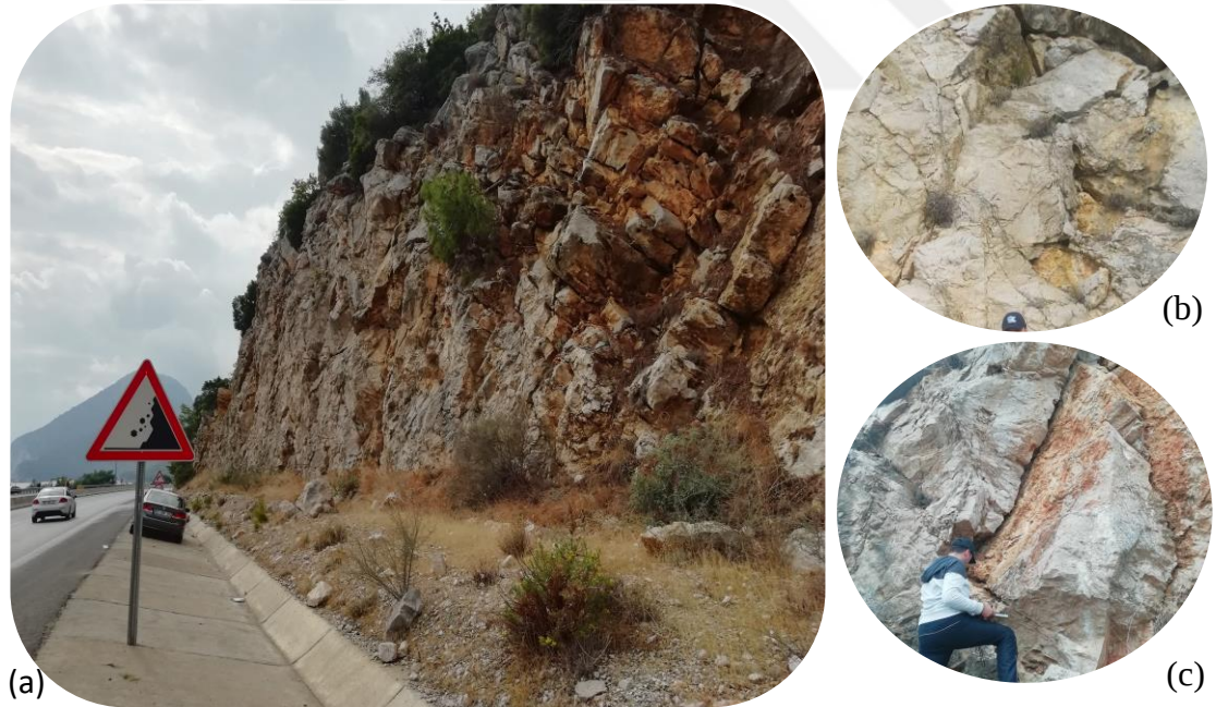
Şekil 4.3. a) 1 nolu lokasyonda 1 nolu şeve ait genel görünüm; b) ve c) de çatlakların detaylı görünümü
