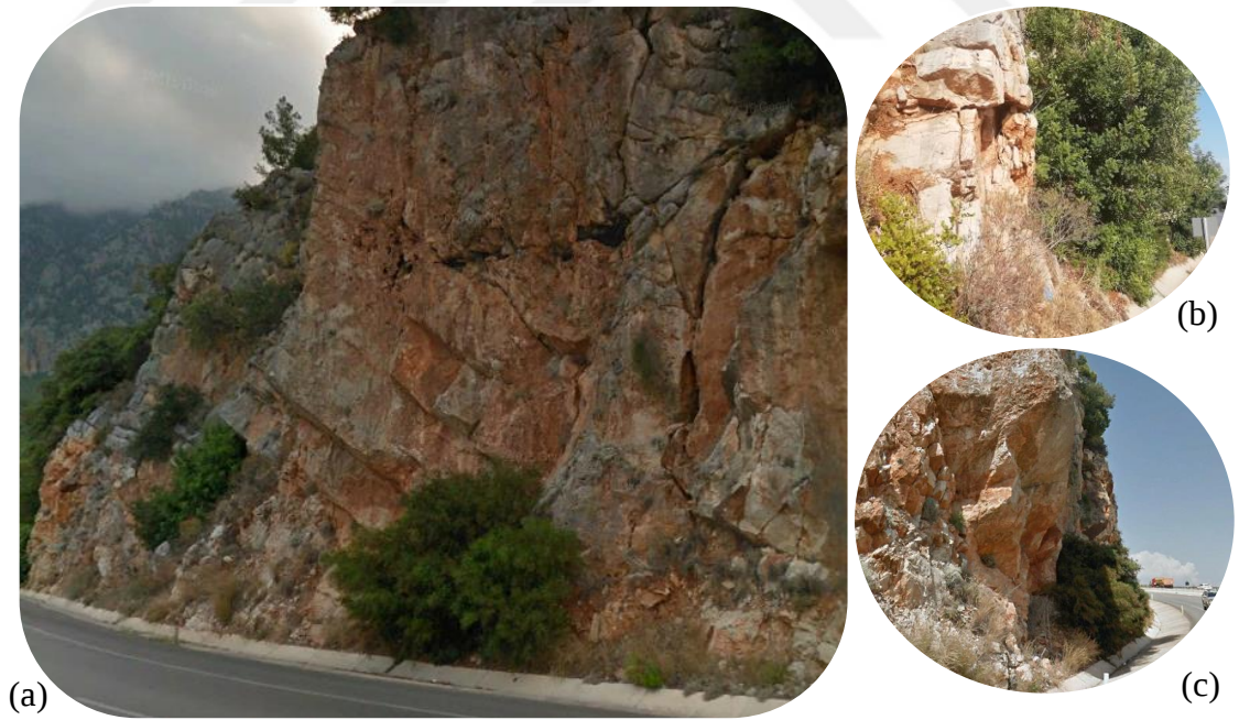
Şekil 4.5. a) 1 nolu lokasyonda 3 nolu şeve ait genel görünüm; b) ve c) de çatlakların detaylı görünümü
