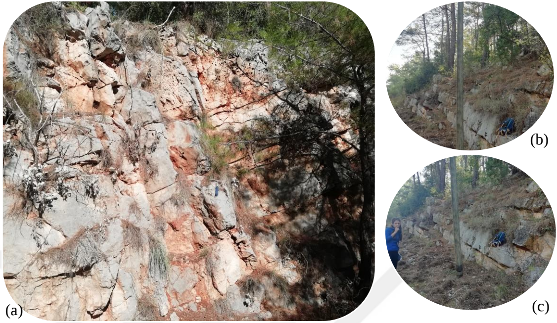
Şekil 4.12. a) 4 nolu lokasyonda 10 nolu şeve ait genel görünüm; b) ve c) de çatlakların detaylı görünümü
