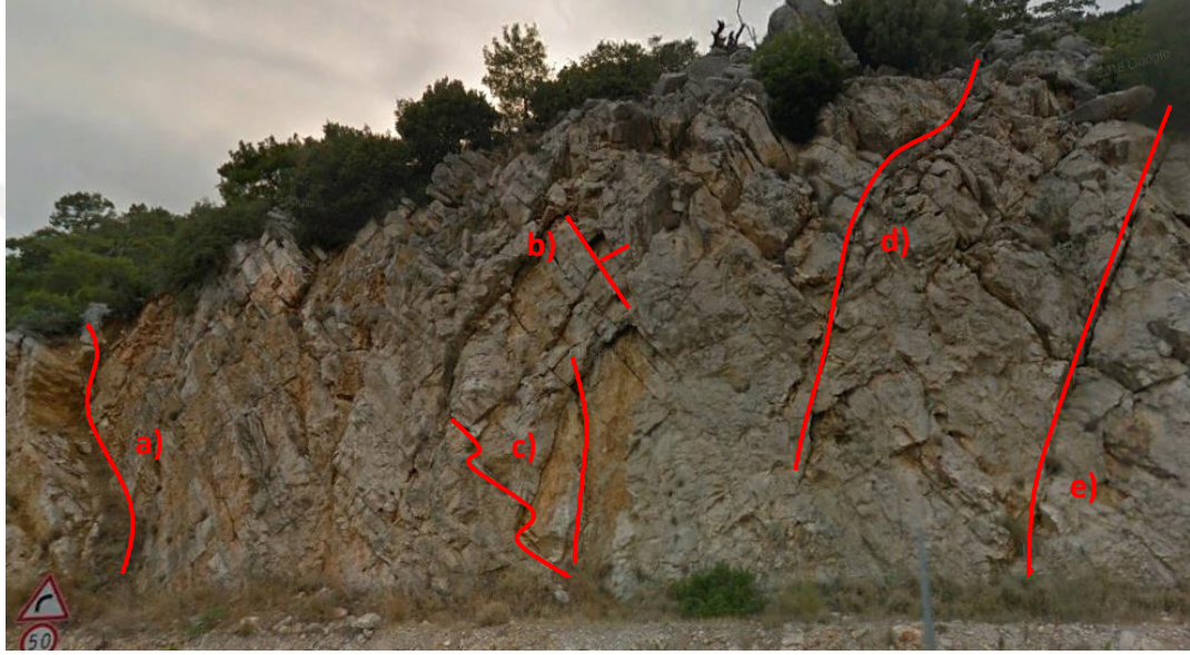
Şekil 4. 1 nolu lokasyonda, karayolu kenarındaki 1 nolu şeve ait çatlak (a, c, d, e) ve tabaka duruşu görünümleri (b)
