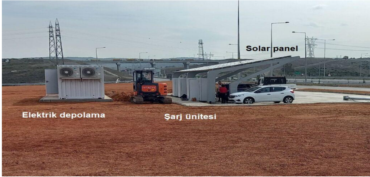
Resim 4.4. Kalyon EV tarafından kurulumu yapılan kuzey marmara otoyolu şarj istasyonu (Tehad, 2021)
