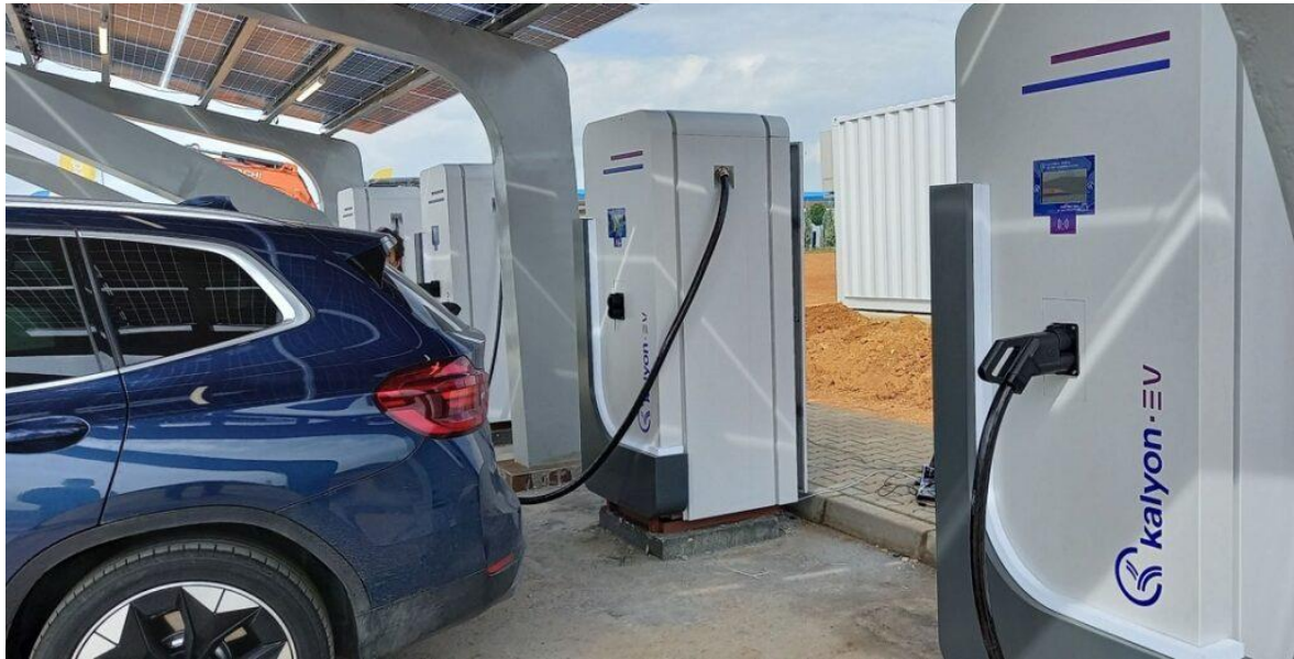
Resim 4.5. Kalyon EV tarafından kurulumu yapılan kuzey marmara otoyolu şarj istasyonu (Tehad, 2021)
