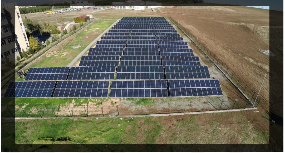
Şekil 1.6. Dicle Üniversitesinde Kurulmuş 250 kW'lık Güneş Santrali
