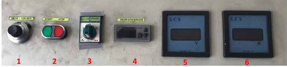
Resim 3.5 Dinamo ve motor kontrol paneli.
