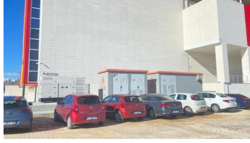
Şekil 4.28. Alan içerisindeki pano, otopark ve trafo
