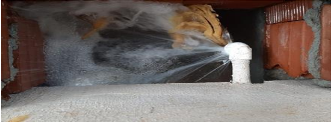
Şekil 3.1. Servis bağlantısı sızıntıları
