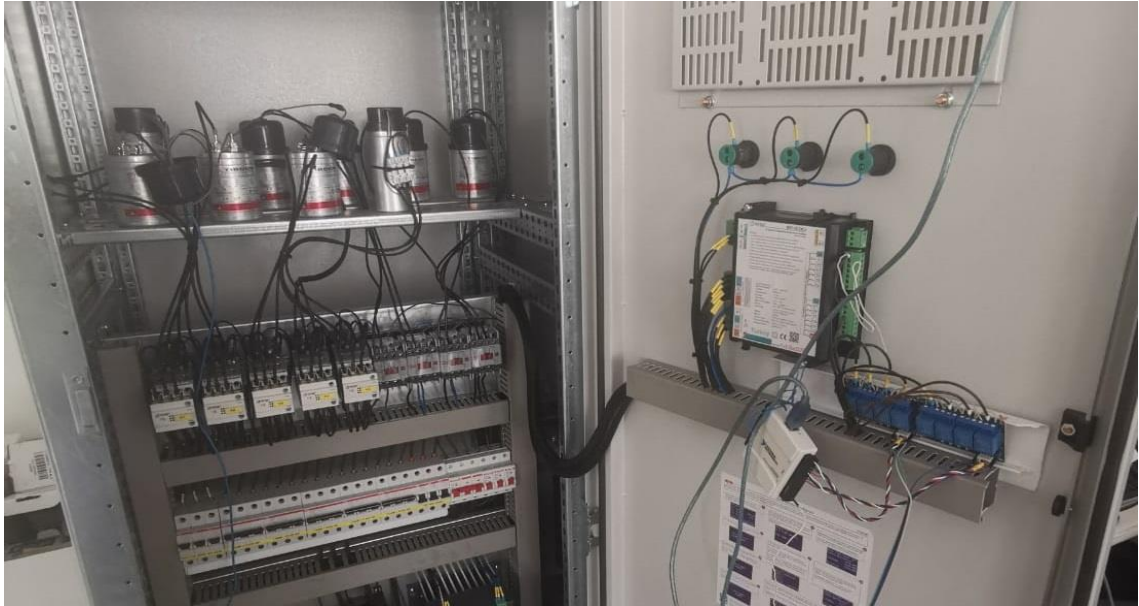
Şekil 4.27. Deneyisel çalışmalarda kullanılan kondansatörlerin ve ilgili donanımın görünümü
