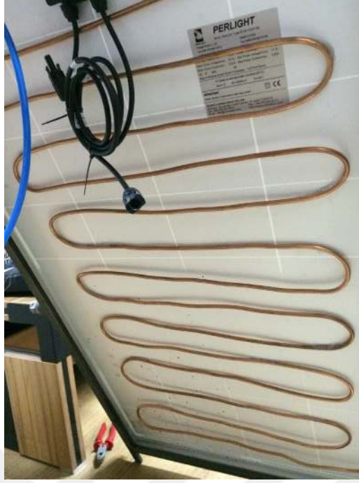
Şekil 3.21 Panel su ısıtma sistemi.
