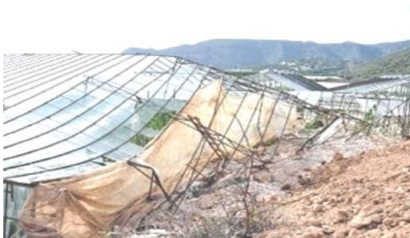
Şekil 2.2.Antalya Demre İlçesinde Hortum Nedeniyle Oluşan Sera Çökmesi
