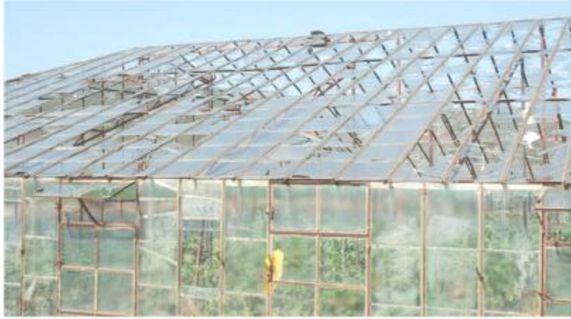
Şekil 2.1.Yanlış Malzeme Seçimi Nedeniyle Antalya'nın Gazipaşa İlçesi'nde Meydan Gelen Dolu Yağışı Sonucunda Oluşan Hasar.
