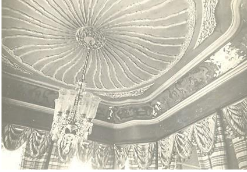
Fotoğraf 77: Tezyinat Restorasyonu Öncesi Servis Odası, 1982-87 46
