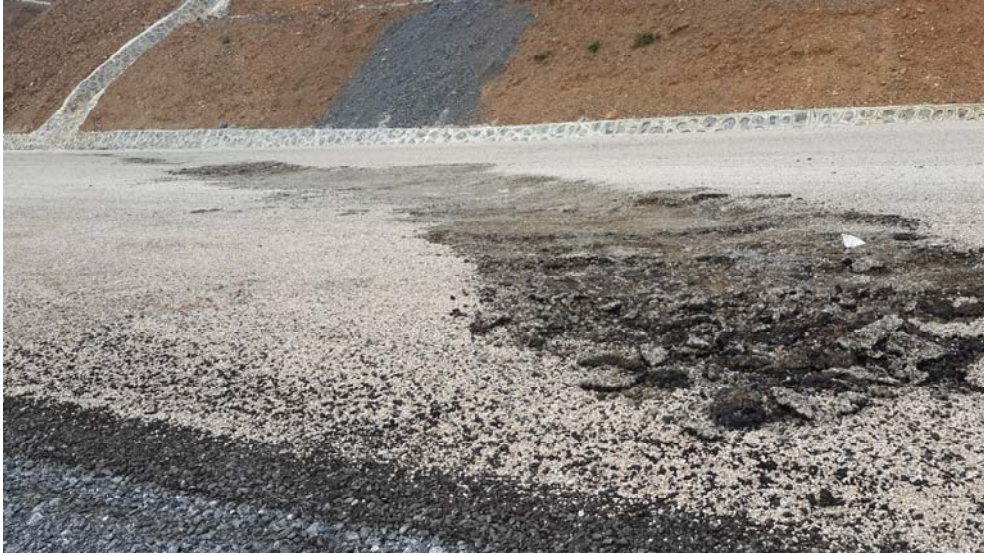
Şekil 4.19. Mevcut yol üzerinde heyelandan dolayı meydana gelen çatlaklar ve oturmalar
