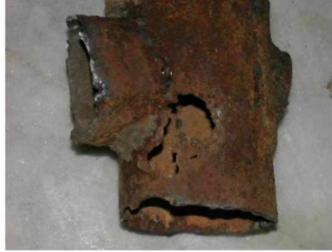
Şekil 2.11 Delik (Pitting) korozyonuna uğramış boru [19]
