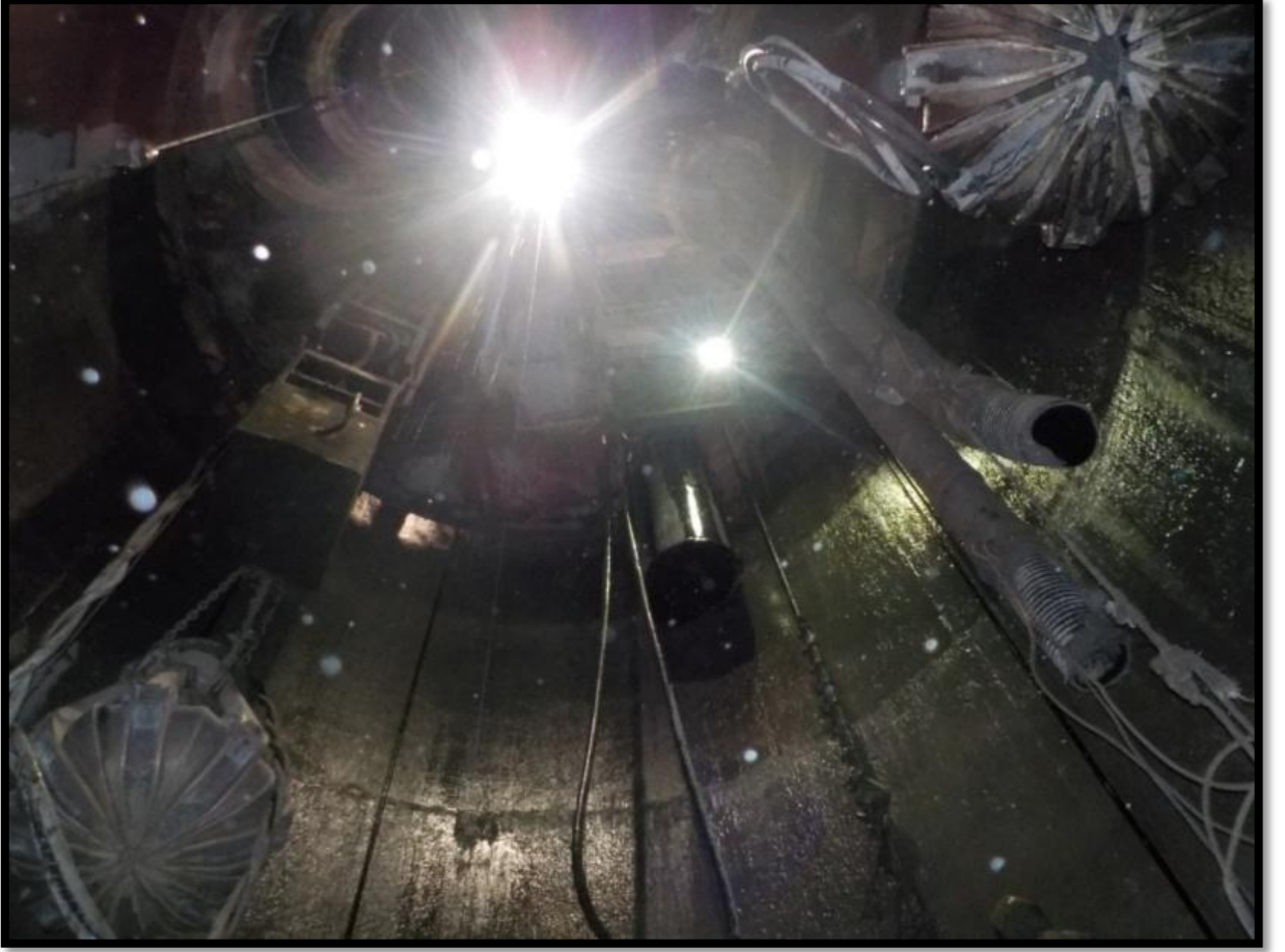
Şekil 4.25. Platformun altında görülen 80 cm çaplı fan tüp
