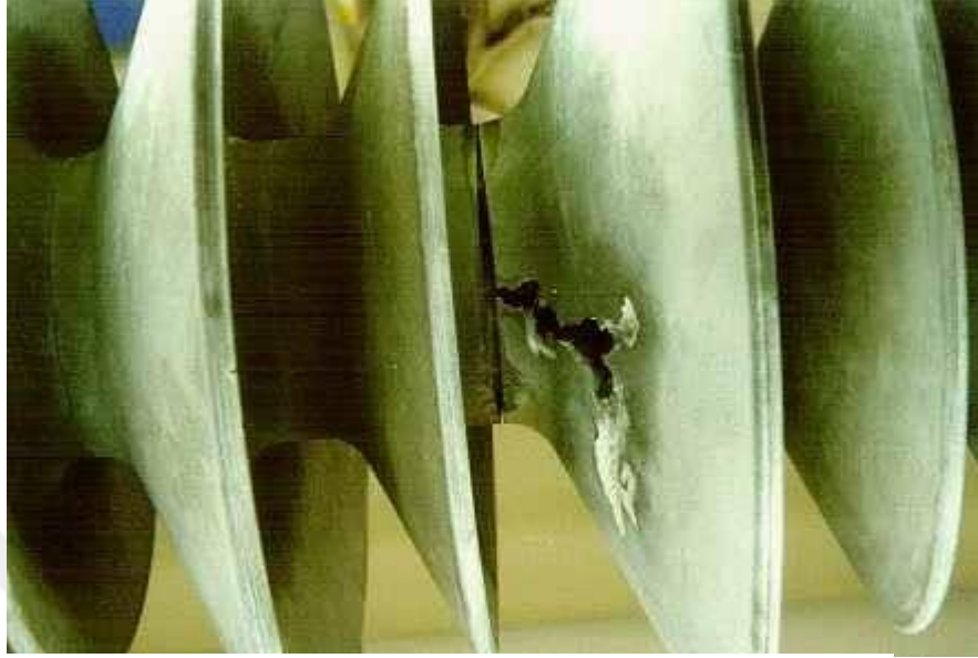
Şekil 2.8. Delinmiş silikon izolatör
