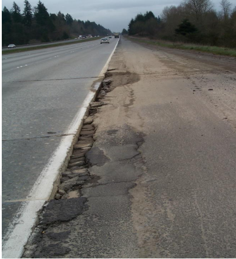
Şekil 2.16. Beton yollarda oluşan pompalama sorunu [71]
