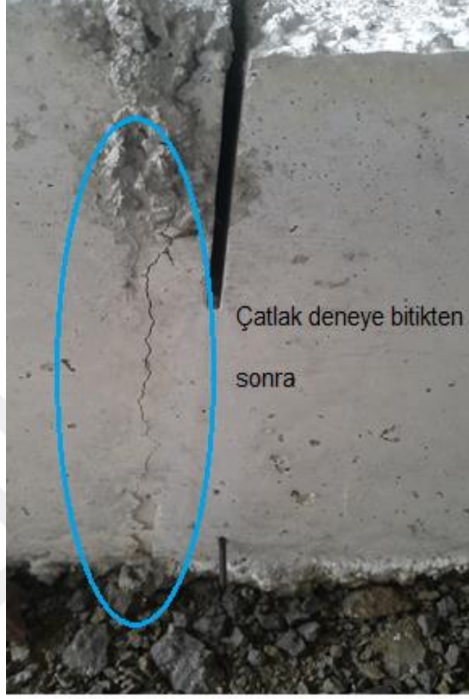
Şekil 4.88. 50.000 yükleme uygulanmasından sonrası çatlak açıklığının gelişimi
