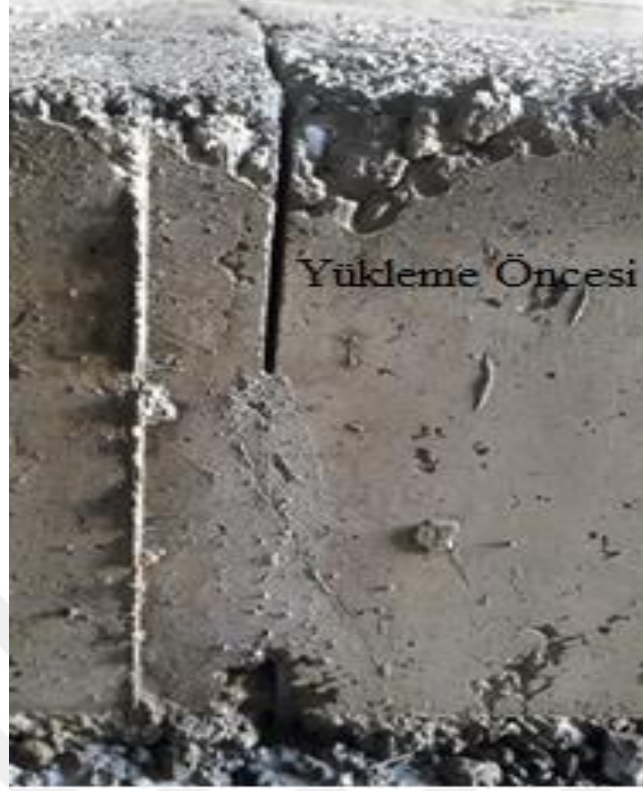
Şekil 4.83. 1.000 yükleme uygulanmasından sonrası çatlak açıklığının gelişimi
