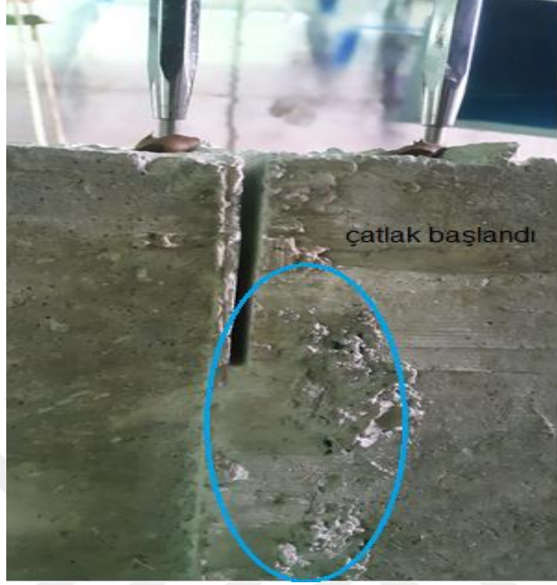
Şekil 4.72. 30.000 yükleme uygulanmasından sonrası çatlak açıklığının gelişimi
