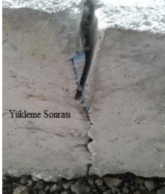
Şekil 4.76. 50.000 yükleme uygulanmasından sonrası çatlak açıklığının gelişimi
