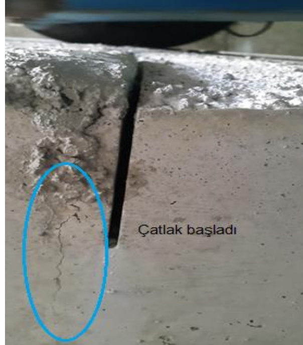
Şekil 4.87. 30.000 yükleme uygulanmasından sonrası çatlak açıklığının gelişimi
