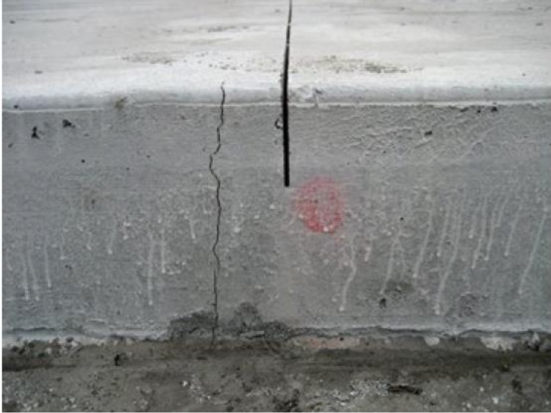
Şekil 2.19. Derz kesimine paralel dik şekilde gelişen çatlak [72]
