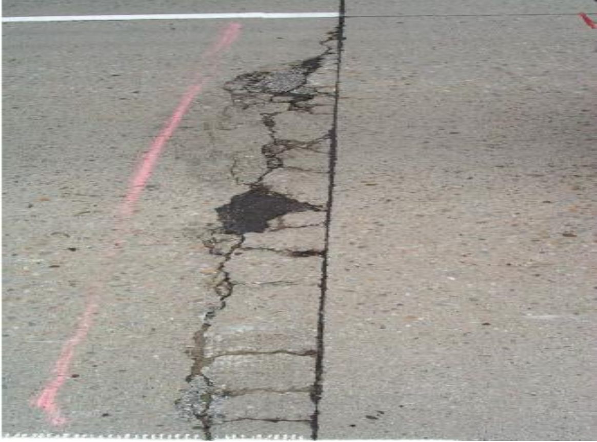
Şekil 2.20. Kayma donatılarının yanlış hizalanmasına bağlı oluşan çatlaklar [72]
