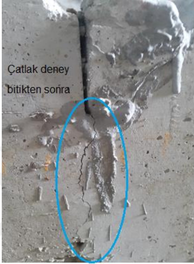
Şekil 4.79. 50.000 yükleme uygulanmasından sonrası çatlak açıklığının gelişimi
