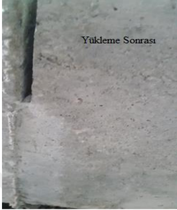
Şekil 4.82. 50.000 yükleme uygulanmasından sonrası çatlak açıklığının gelişimi
