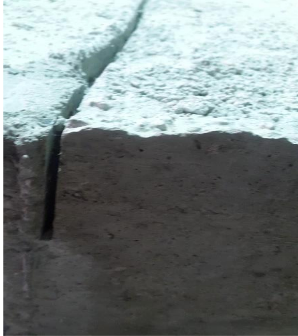
Şekil 4.81. 30.000 yükleme uygulanmasından sonrası çatlak açıklığının gelişimi
