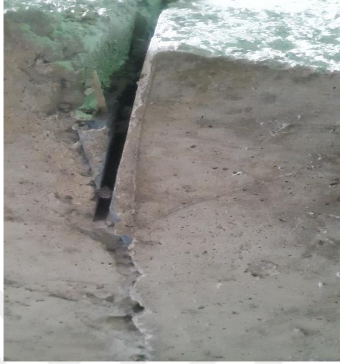
Şekil 4.75. 30.000 yükleme uygulanmasından sonrası çatlak açıklığının gelişimi
